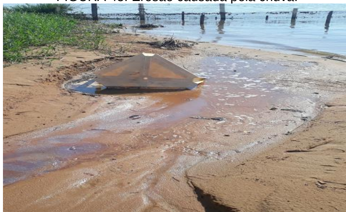
FIGURA 45: Erosão causada pela chuva.
