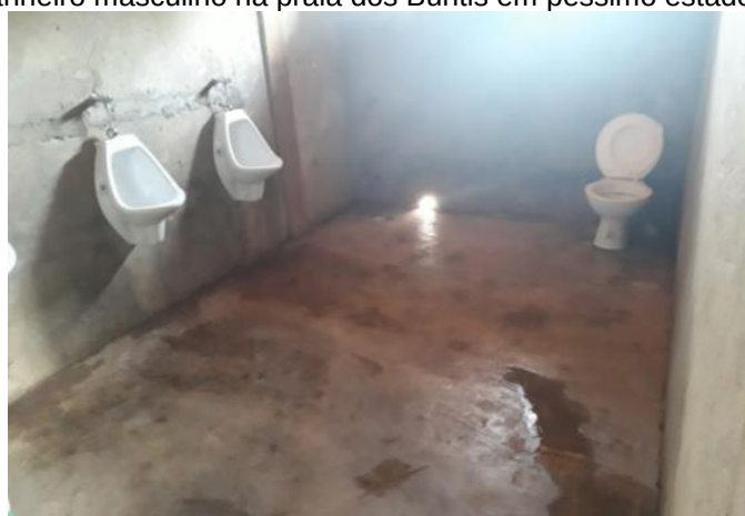
FIGURA 49: Banheiro masculino na praia dos Buritis em péssimo estado de uso.
