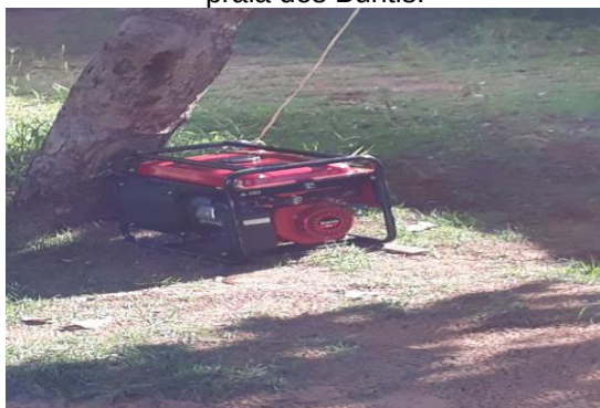
FIGURA 47: Gerador de energia na praia dos Buritis.
