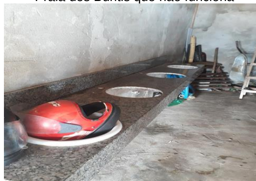
FIGURA 48: Pias do banheiro da Praia dos Buritis que não funciona
