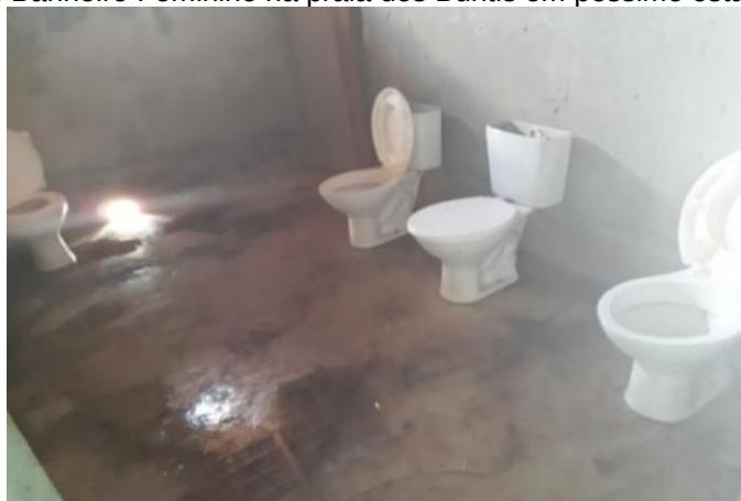
FIGURA 50: Banheiro Feminino na praia dos Buritis em péssimo estado de uso.
