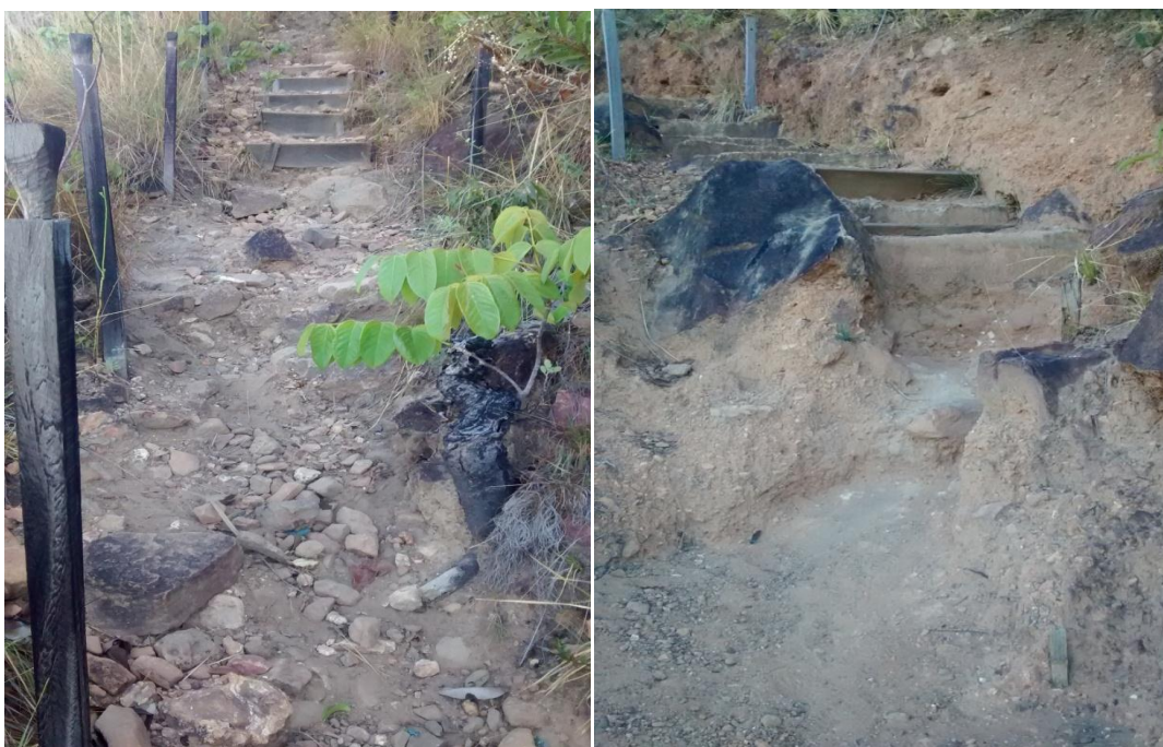
Figura 41 - Ponto 26 e 32– Degraus existentes
