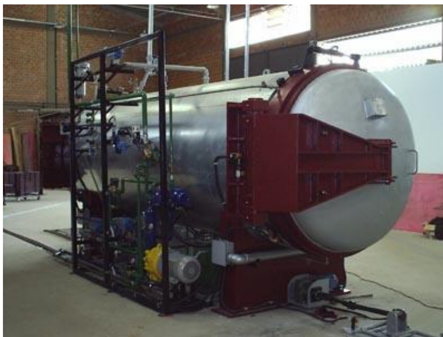
Figura 2 – Autoclave utilizado para tratamento de RSS
