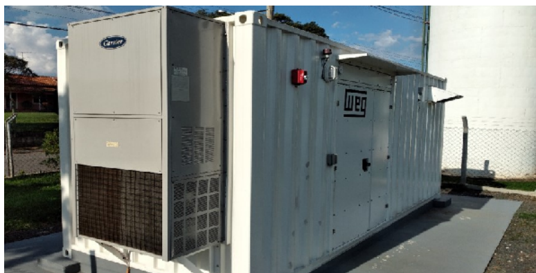
Imagem 2 – Sistema de armazenamento de energia em bateria - BESS
