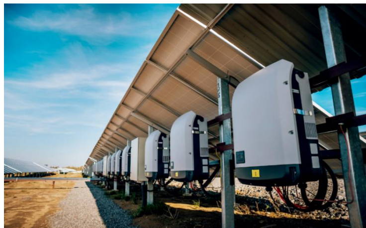
Figura 10 - Inversores fotovoltaicos in loco.
