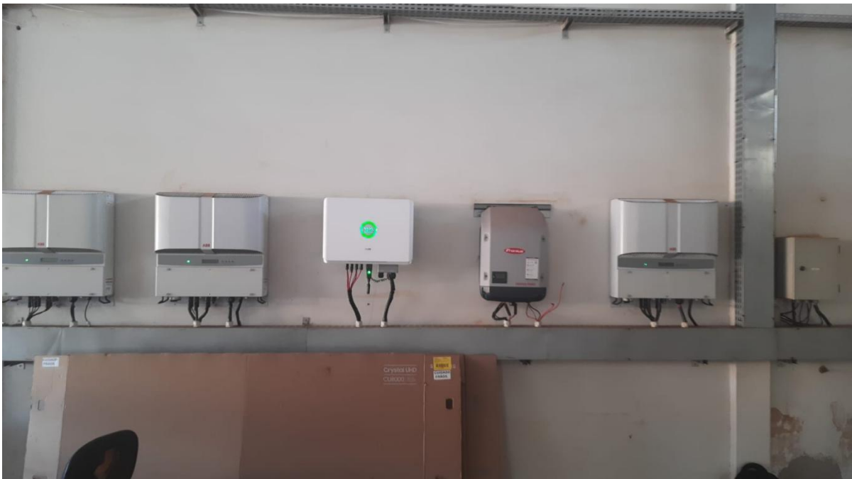
Figura 22 - Inversores fotovoltaicos bloco 9.
