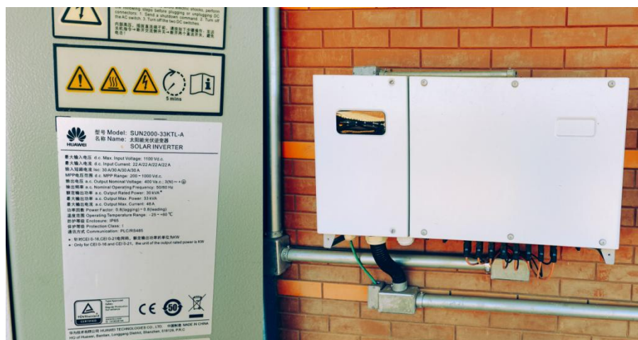
Figura 21 - Inversor fotovoltaico bloco 7.
