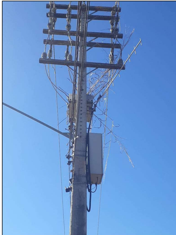
Figura 18: Estrutura do Religador 7905362122 após a ocorrência. Fonte: Energisa, 2020
