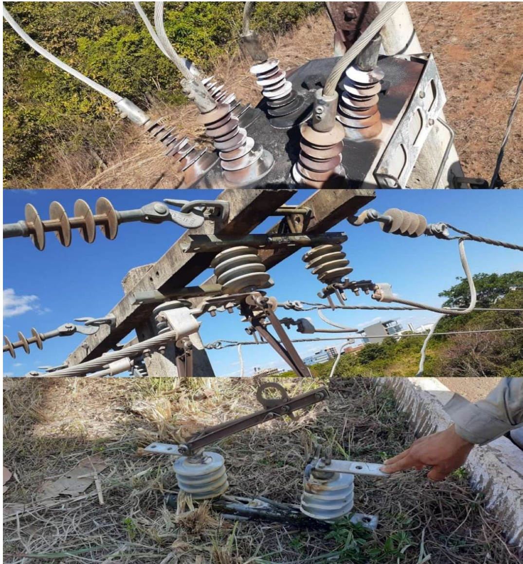
Figura 21: Danos na Estrutura do Religador 7905362122 após a ocorrência. Fonte: Energisa, 2020
