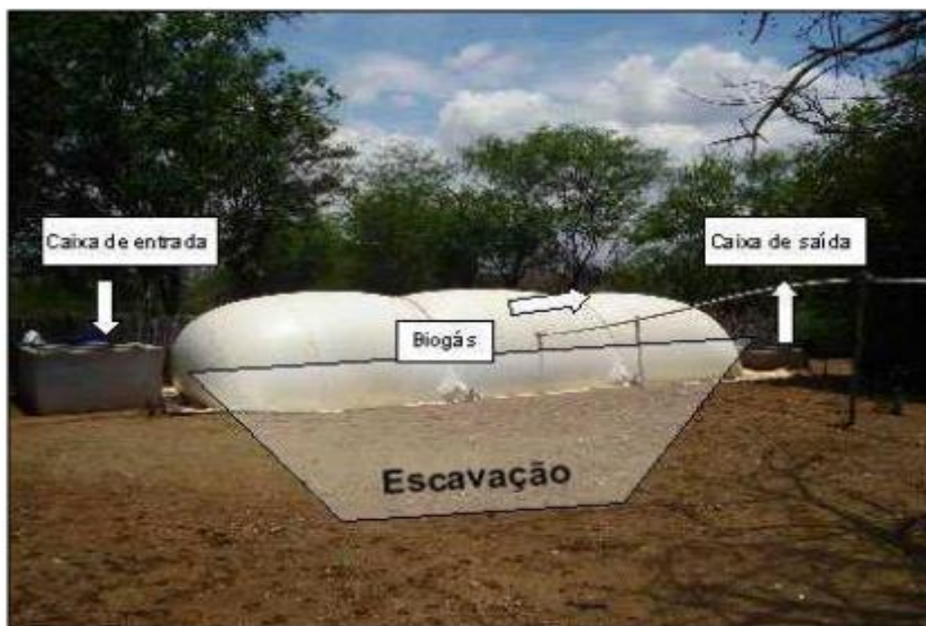
Figura 8 - Biodigestor canadense instalado
