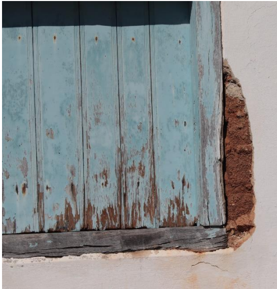
Figura 26 - Desplacamento da alvenaria
