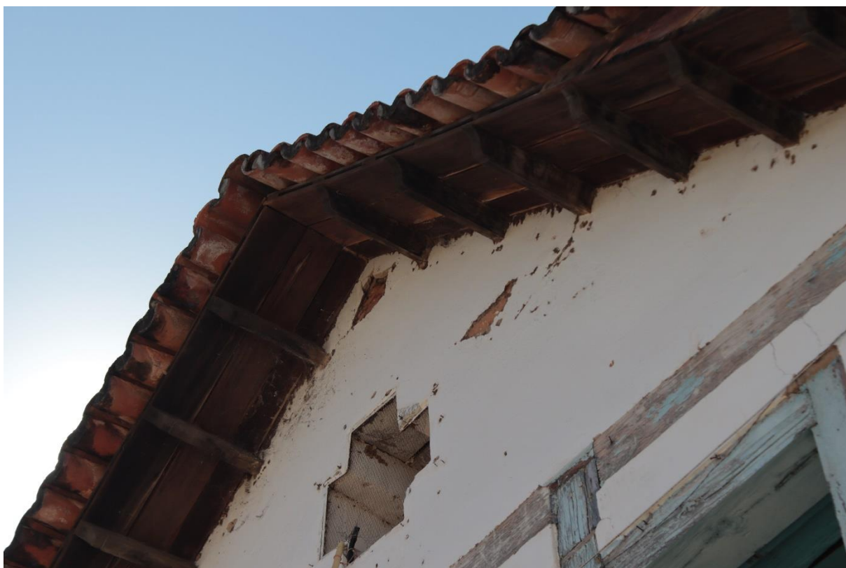
Figura 9 - Desintegração do reboco
