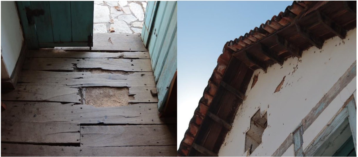
Figura 7 - Desgaste dos revestimentos
