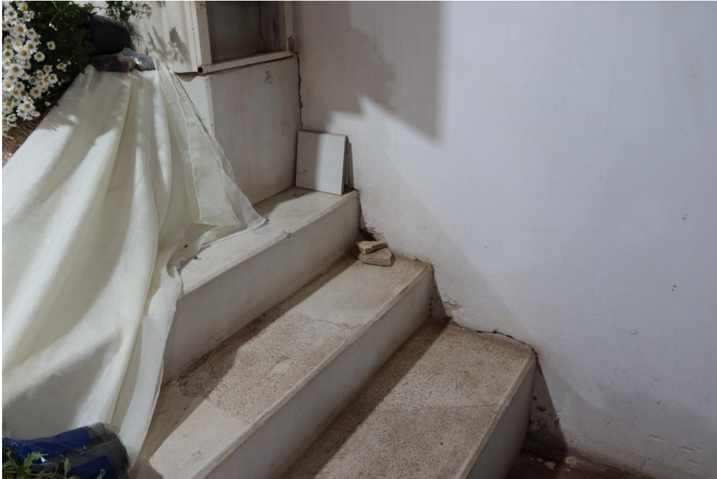
Figura 39 - Parade da escadaria do altar com fissuras
