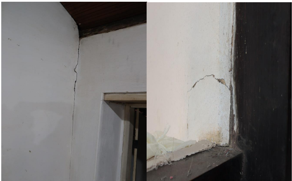
Figura 10 - Fissura horizontal na parede
