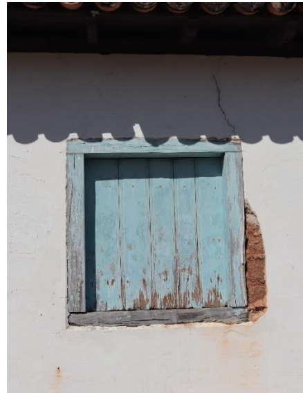
Figura 27 - Degradação da madeira da janela
