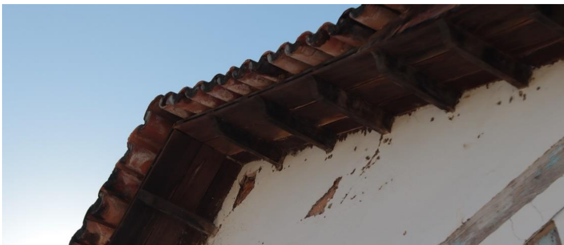
Figura 22 - Desplacamento de reboco
