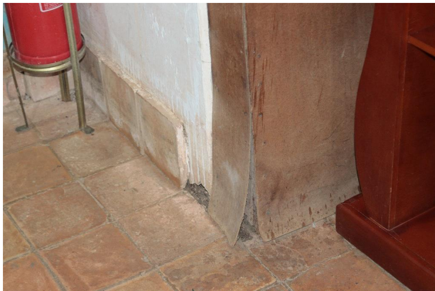
Figura 43 - Deteriorização da madeira e presença de cupim
