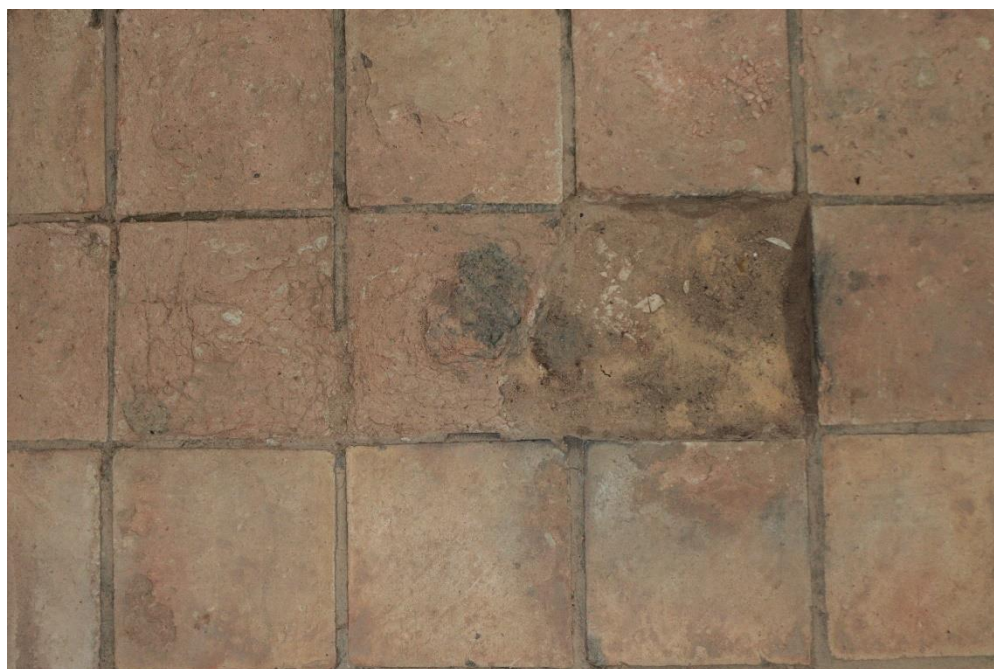
Figura 41 - Patologia no piso do segundo cômodo
