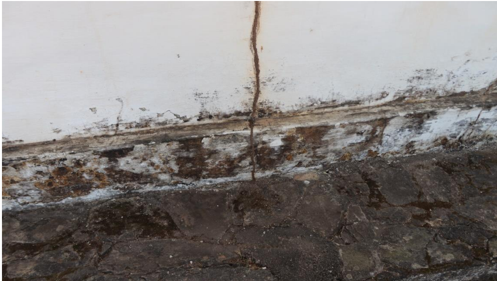
Figura 11 - Infiltração e umidade
