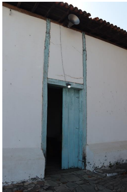
Figura 30 - Fissuras e degradação da madeira
