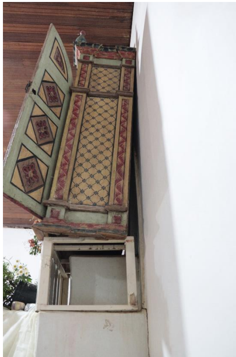
Figura 37 - Móvel do altar danificado
