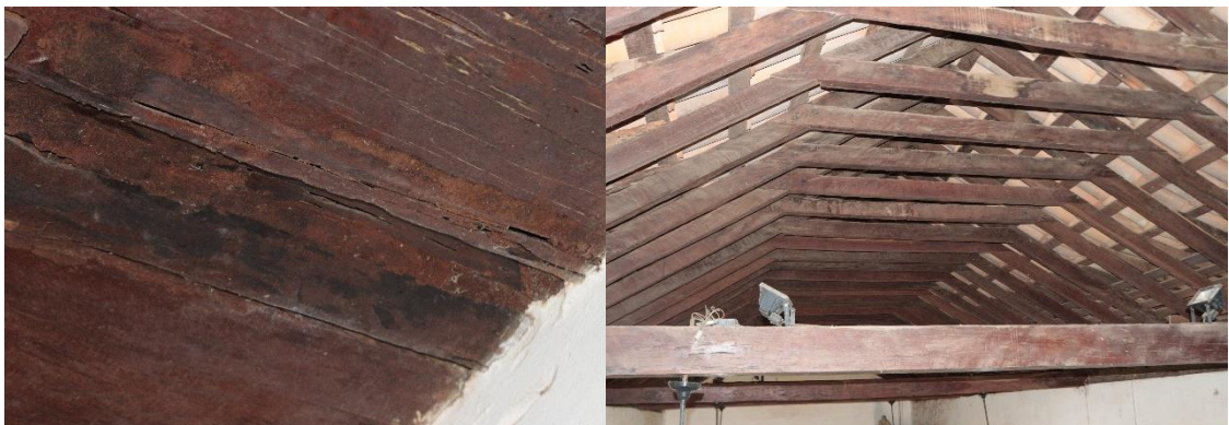
Figura 34 - Umidade na madeira do teto
