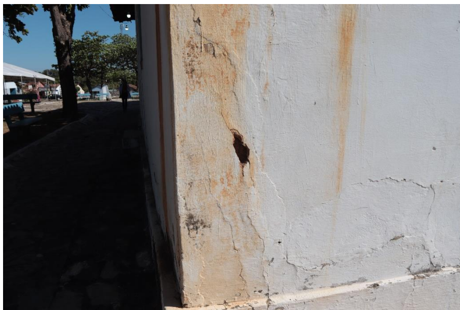
Figura 46 - Patologia na parede
