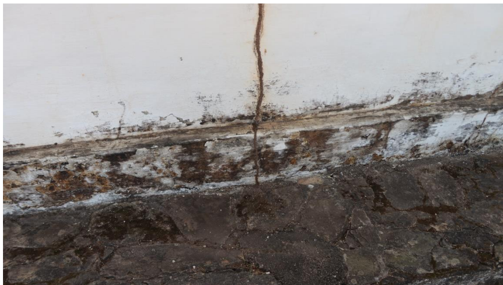
Figura 6 - Infiltração e umidade
