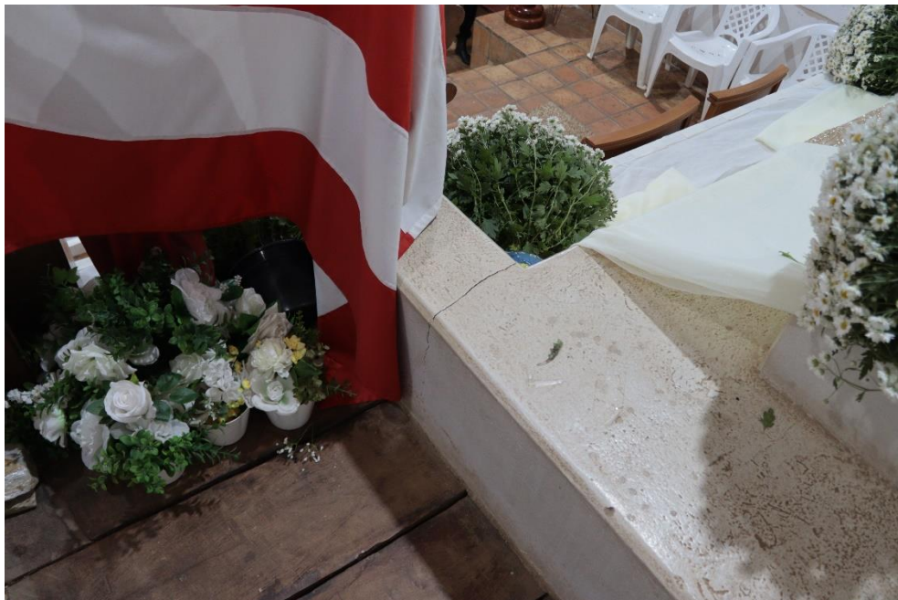
Figura 40 - Mármore do altar com fissuras
