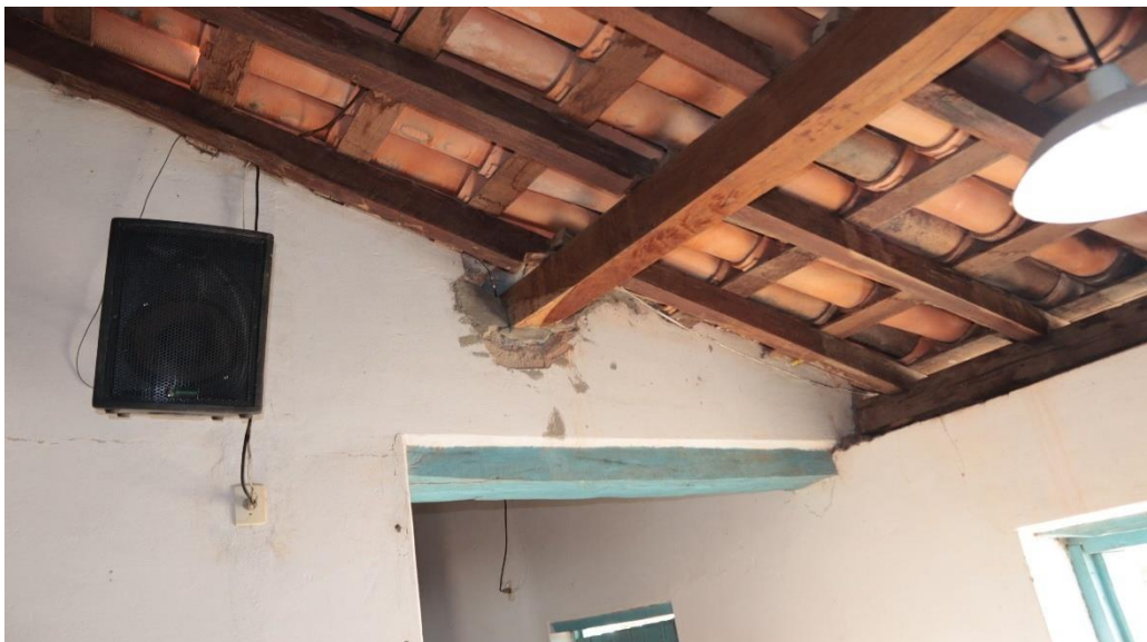
Figura 8 - Problemas de adesão entre os materiais
