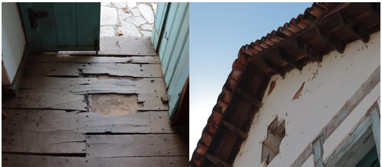
Figura 12 - Desgaste dos revestimentos
