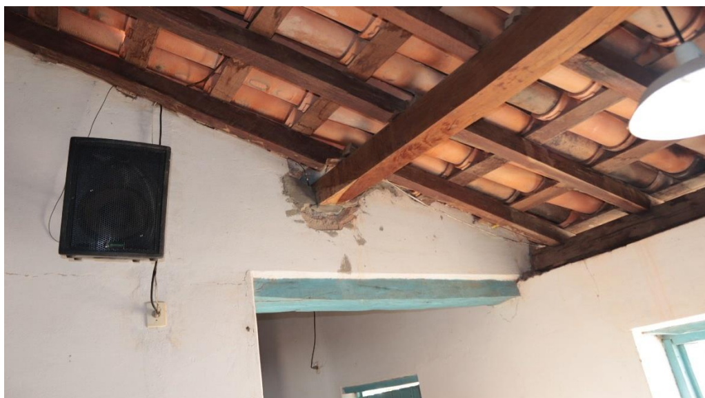
Figura 13 - Problemas de adesão entre os materiais
