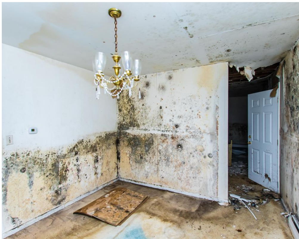
Figura 14 – Manifestação de mofo e bolores nas paredes e forro da edificação
