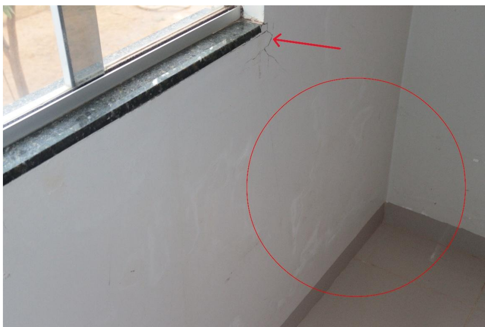
Figura 49 – Fissura decorrente da concentração de tensões e manchas de umidade
