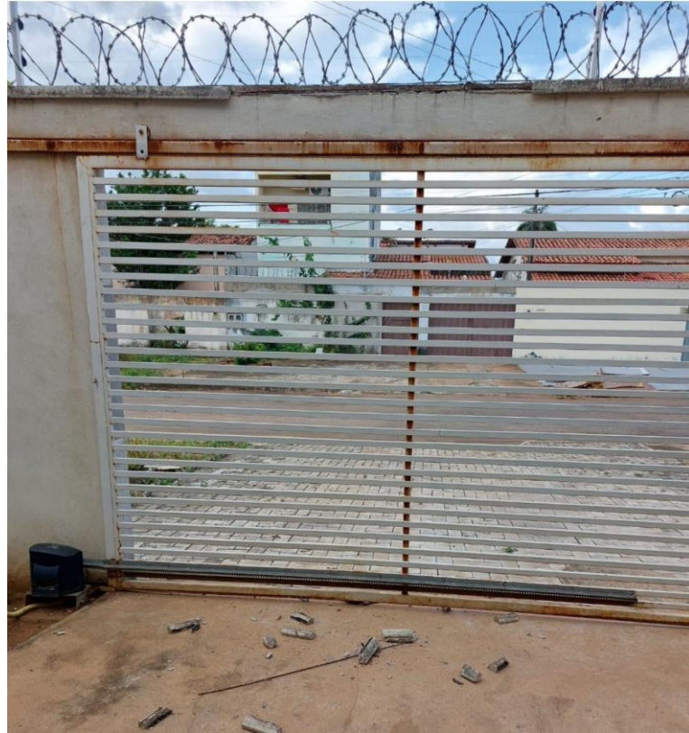
Figura 35 – Degradação da pingadeira do muro
