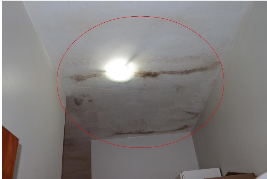
Figura 33 – Mofos e bolores na Laje de cobertura
