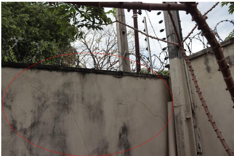
Figura 36 – Fissuras mapeadas e manchas no muro
