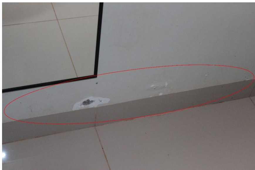
Figura 38 – Empolamento e deslocamento na base da parede interna da residência
