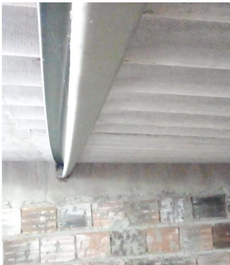
Figura 29 – Estrutura metálica da cobertura com flambagem por distorção
