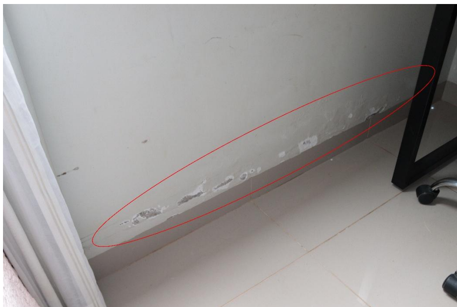
Figura 39 – Empolamento e deslocamento na base da parede interna da residência
