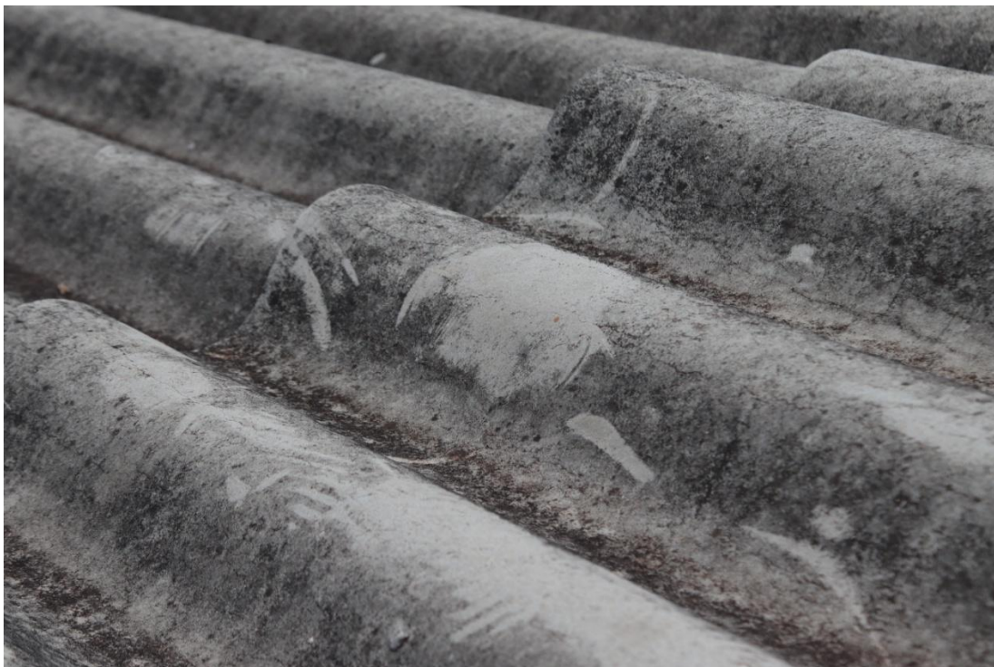
Figura 27 – Porosidade do telhamento em fibrocimento
