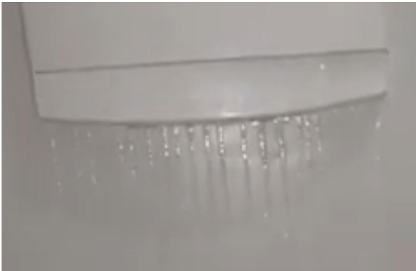
Figura 58 – Vazamento de água pelo quadro de distribuição de energia
