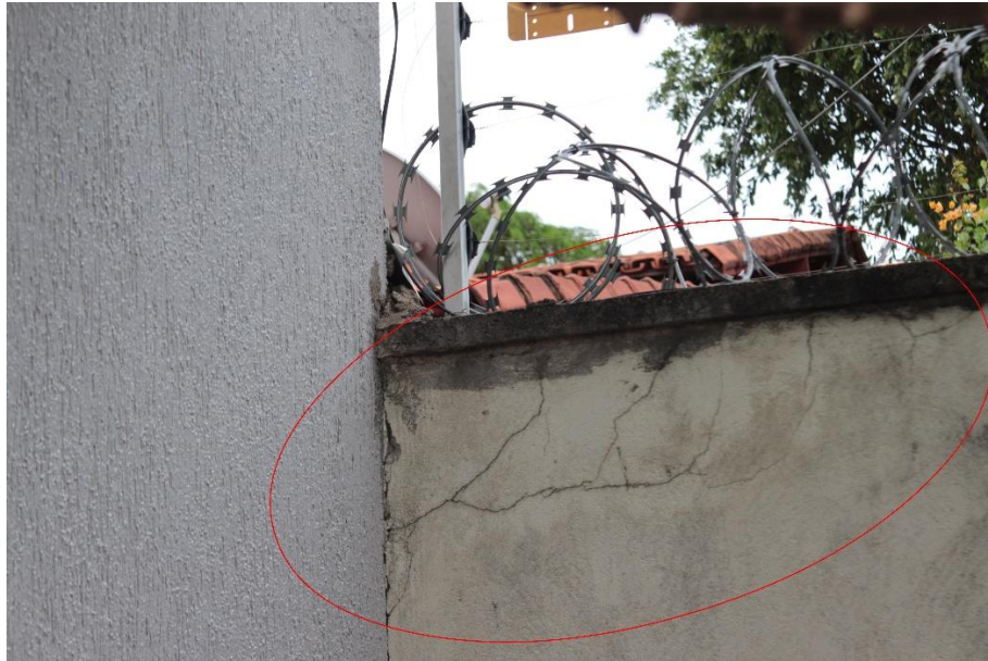
Figura 37 – Fissuras mapeadas e manchas no muro
