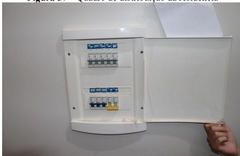
Figura 57 – Quadro de distribuição da residência
