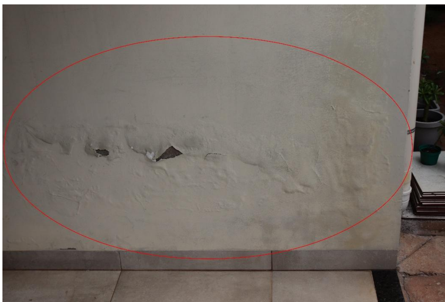
Figura 40 – Empolamento e deslocamento na base da parede da garagem
