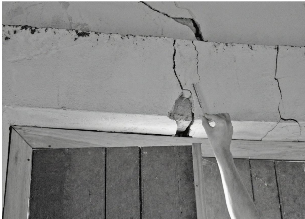
Figura 9 – Representação de trincas no sistema de vedação vertical
