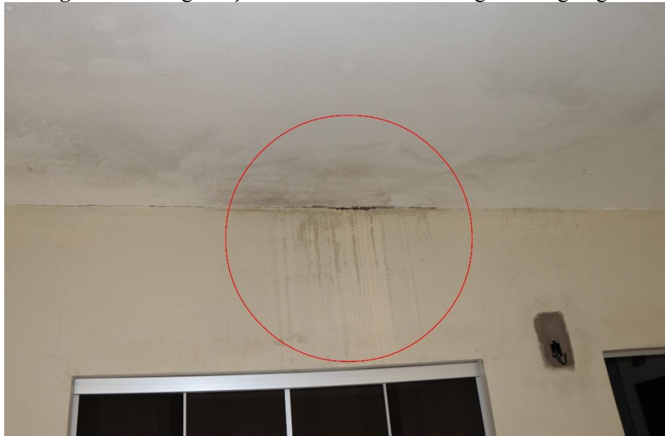
Figura 43 – Degradação e manchas no forro de gesso da garagem
