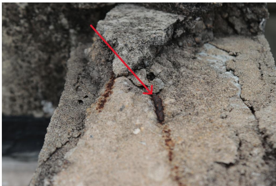
Figura 31 – Armadura da pingadeira de concreto armado exposta
