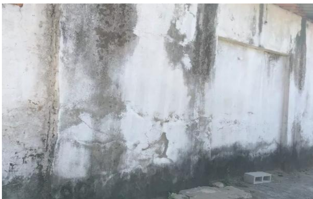
Figura 12 – Manifestação de mofo no muro externo
