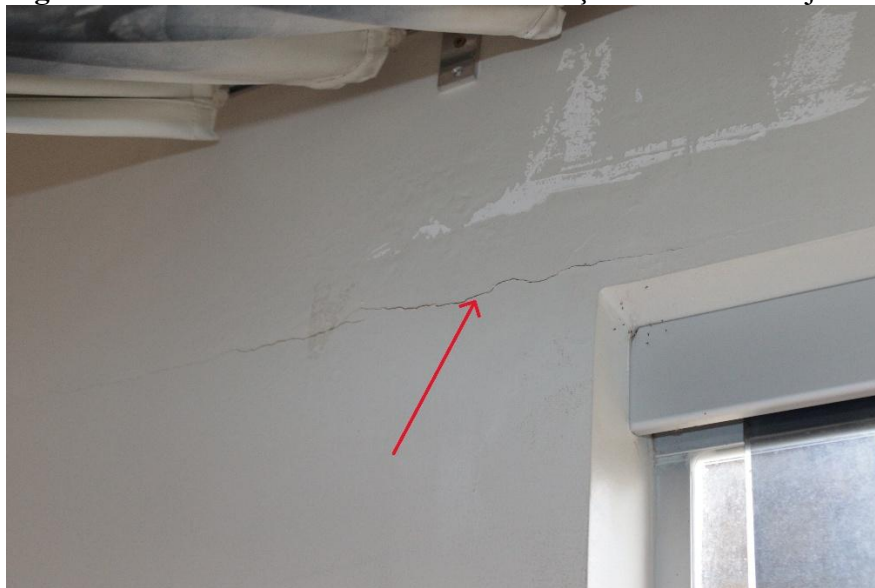
Figura 47 – Fissura decorrente da concentração de tensões na janela
