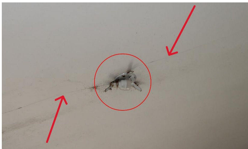
Figura 56 – Luminária com oxidação aparente, fissuras e sinais de infiltração na laje de forro
