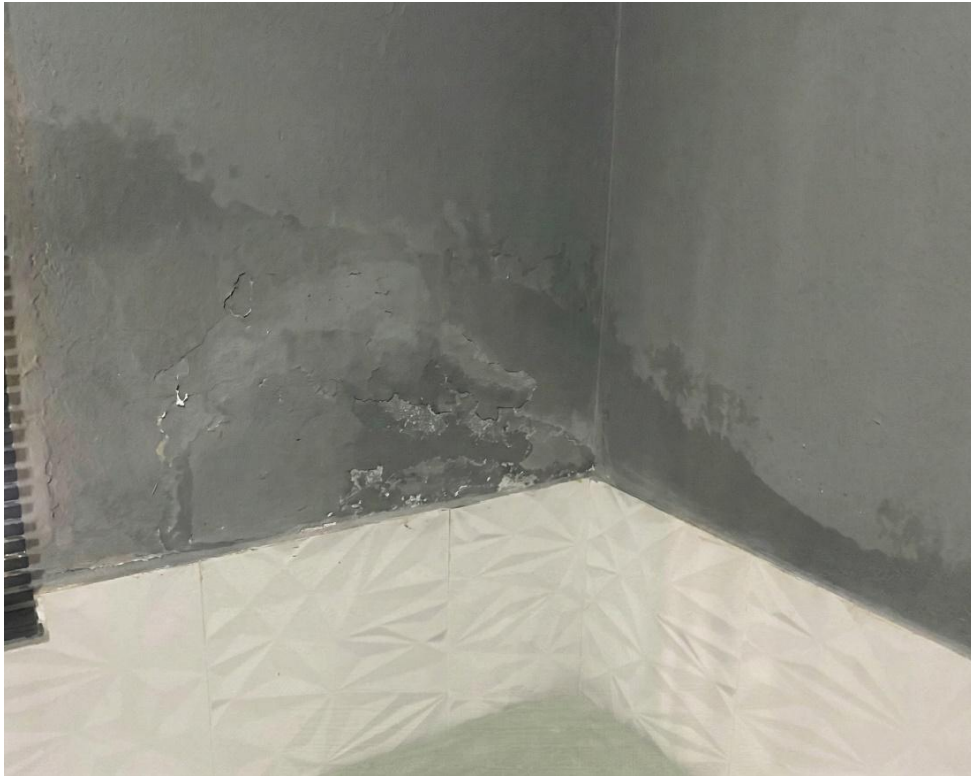
Figura 2 – Infiltração por capilaridade
