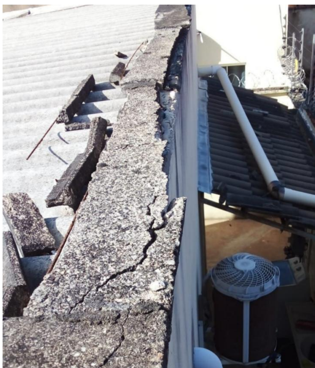
Figura 30 – Deslocamento da pingadeira de concreto armado
