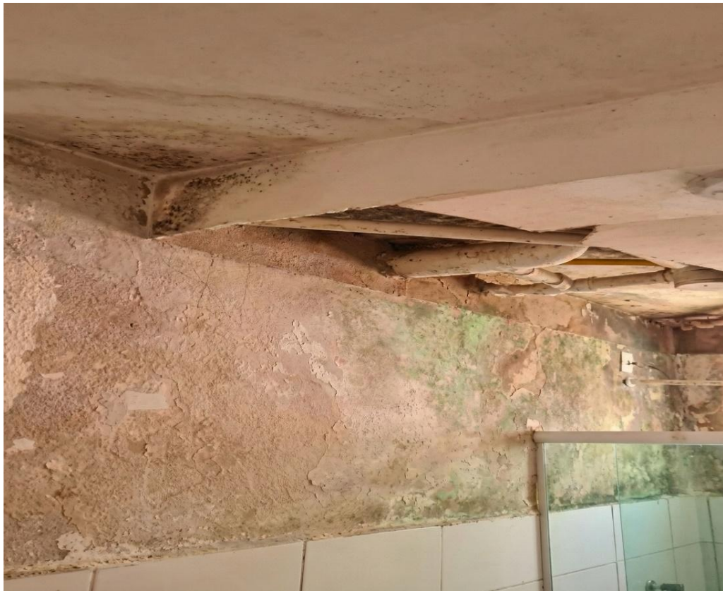
Figura 4 – Infiltração decorrente da instalação hidráulica
