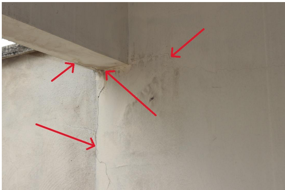
Figura 34 – Trinca de interface devido ao acúmulo de tensões
