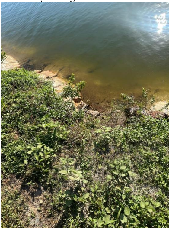
Figura 23 – Vista da crista da barragem e detalhe da borda do reservatório, indicando condições da geomembrana.
