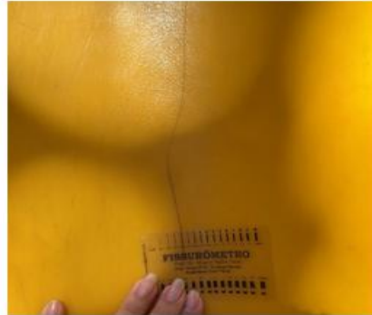
Fissura no escorregador
