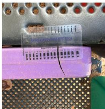
Formação de trinca
