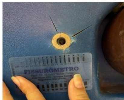
Trincas nas áreas de ligação
