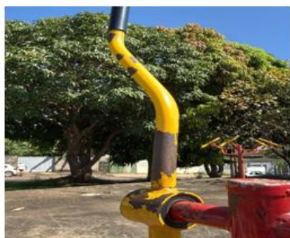
Corrosão de elemento estrutural
