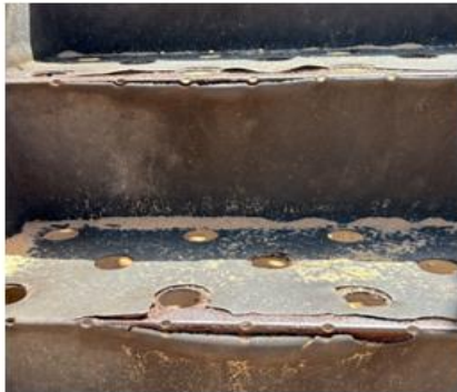
Deformação de revestimento
