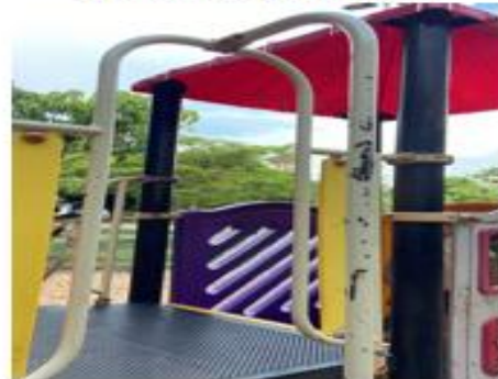
Corrosão em guarda corpo
