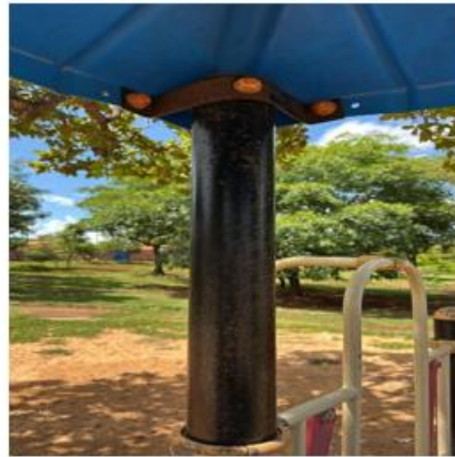
Corrosão de elemento estrutural
