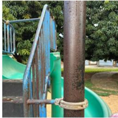
Corrosão de elemento estrutural
