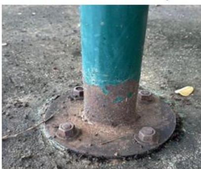
Corrosão da base de fixação
