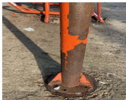
Corrosão e ausência de fixação
