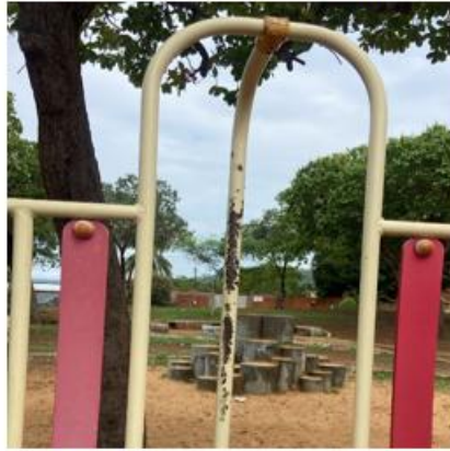
Corrosão de guarda corpo
