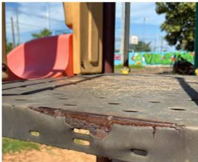
Deformação de revestimento
