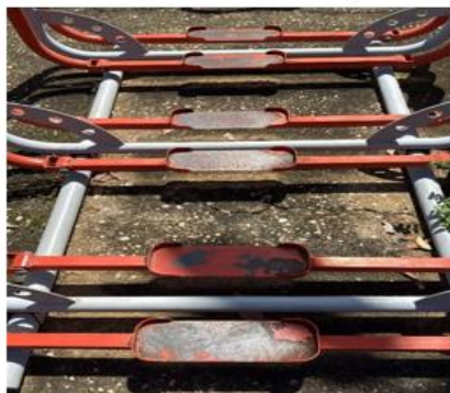
Corrosão de base de apoio
