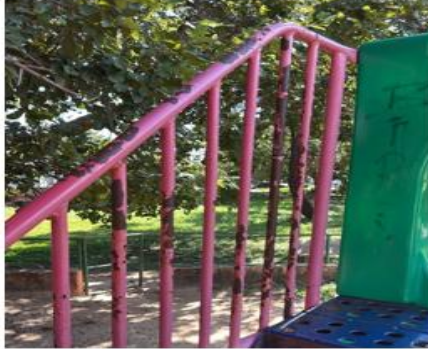
Corrosão em guarda corpo
