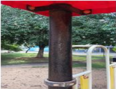
Corrosão em elemento estrutural
