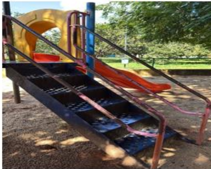
Corrosão de corrimão
