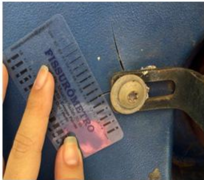
Trincas nas áreas de ligação
