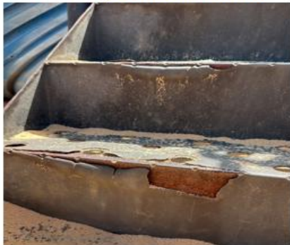
Deformação de revestimento
