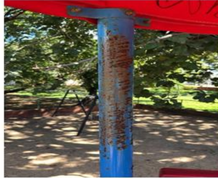
Corrossão elemento estrutural
