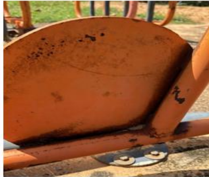
Corrosão de elemento
