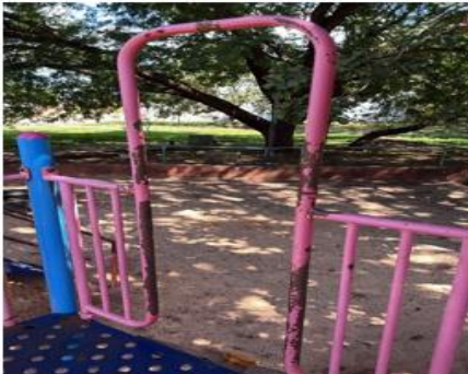
Corrosão em guarda corpo
