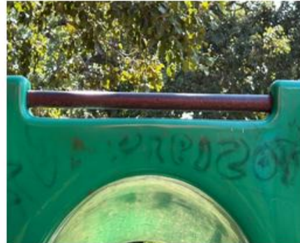
Corrosão elemento tubular
