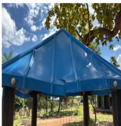
Quebra de elemento de cobertura
