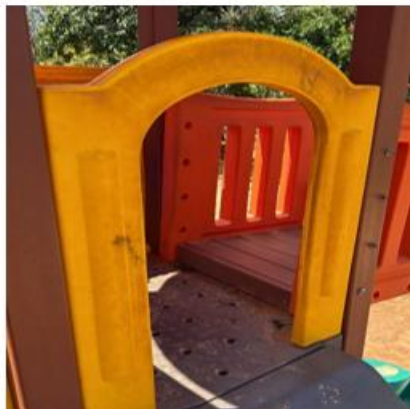
Machas de umidade
