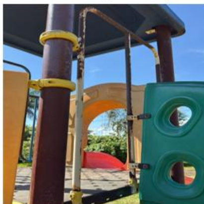
Corrosão de guarda corpo
