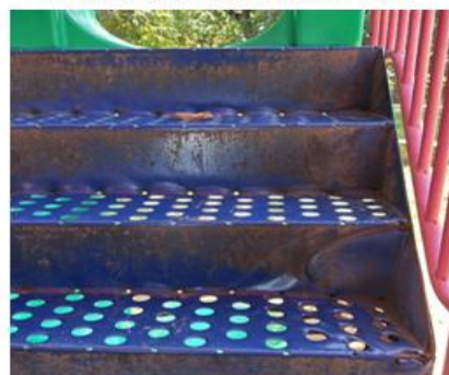
Deformação no revestimento
