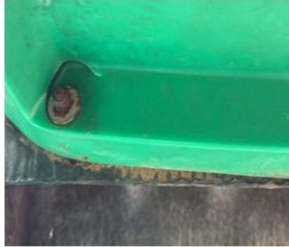
Quebra no sistema de ligação
