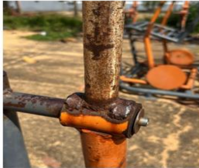
Corrosão na área da solda
