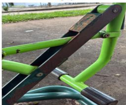
Corrosão da peça estrutural
