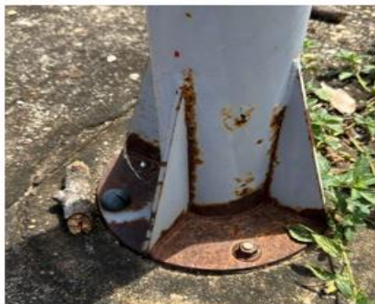
Corrosão de base de fixação
