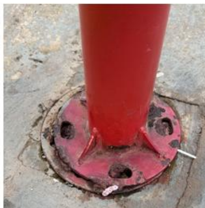
Corrosão da base de fixação
