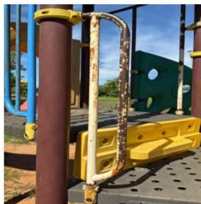
Corrosão de guarda corpo
