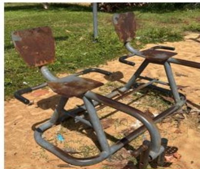
Corrosão de equipamento
