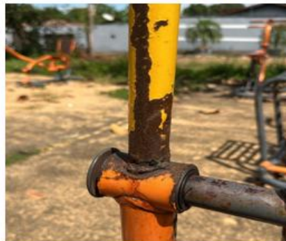
Corrosão na área da solda
