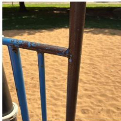
Corrosão de guarda corpo
