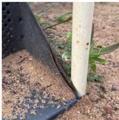
Corrosão da escada
