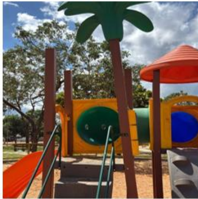
Deformação no elemento estrutural
