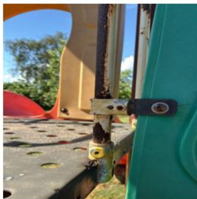
Corrosão de elemento estrutural
