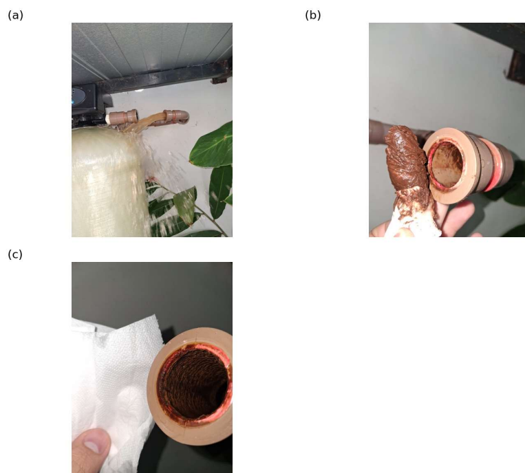
Figura 12 - Registros visuais da entrada de água bruta no sistema filtrante da Residência 01, com presença de coloração acastanhada e material ferruginoso depositado na tubulação
