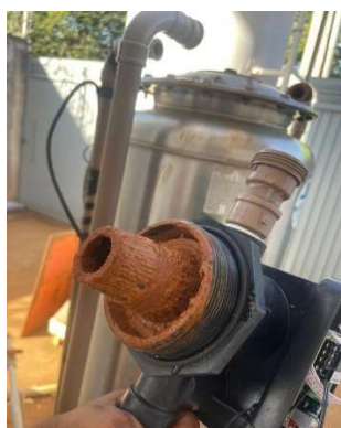
Figura 03 - Deposição de ferro em equipamento de filtragem
