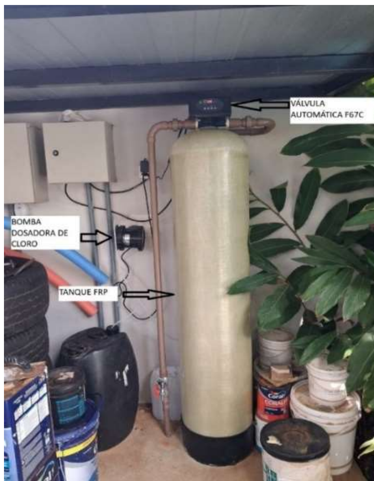
Figura 08 - Filtro FRP com válvula automática e bomba dosadora de cloro
