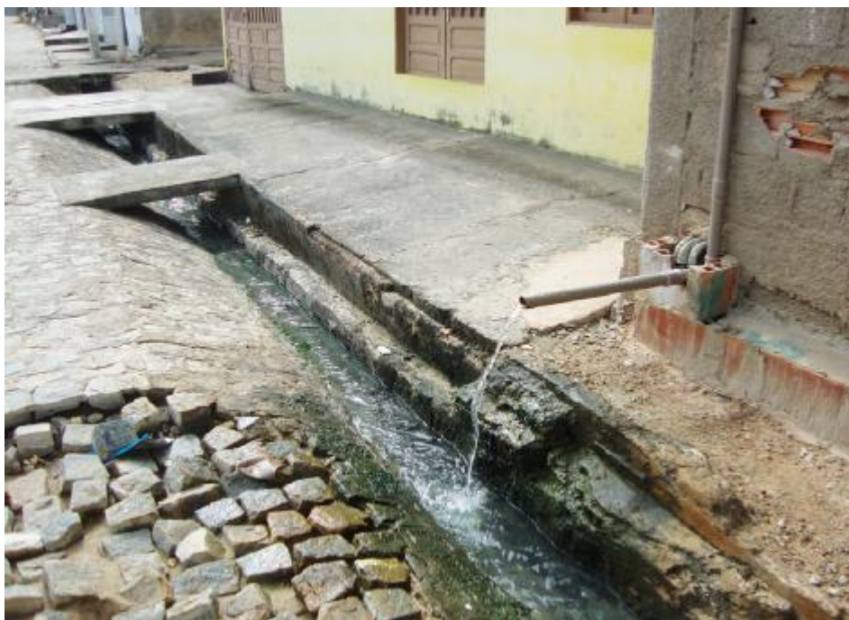
Figura 1 – Lançamento de esgoto diretamente nas ruas de um bairro urbanizado.
