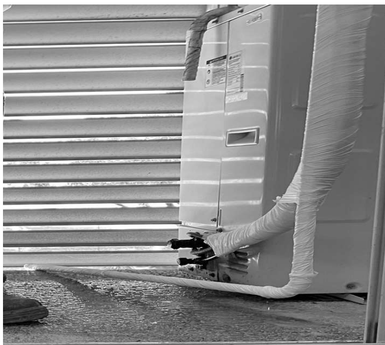
Figura 06 – Extravasamento da água do ar-condicionado
