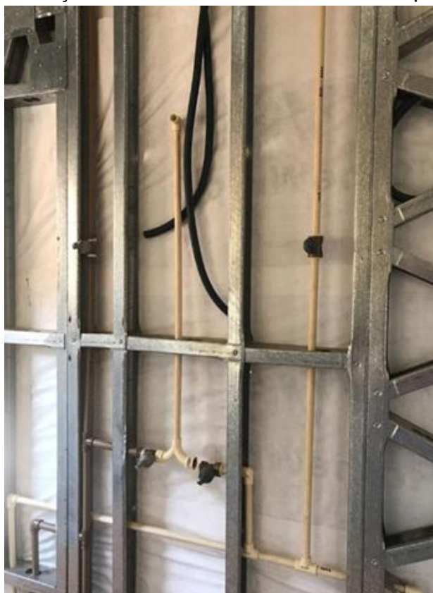
Figura 99 - Tubulação em PVC e CPVC instalada em parede de LSF
