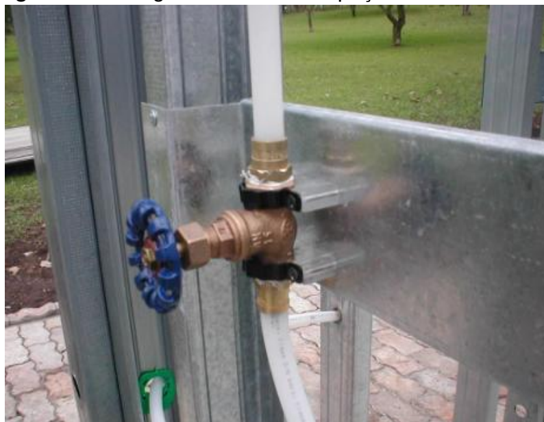
Figura 100 - Registro fixado sobre peça metálica auxiliar
