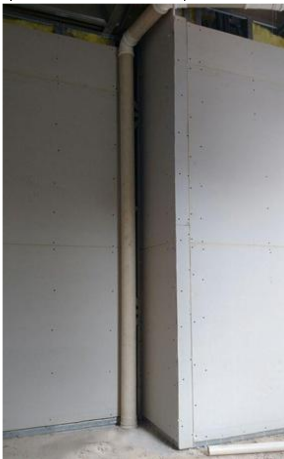
Figura 103 - Tubulação de descida de esgoto diâmetro 100 mm caminhando por fora da parede, a ser envolvida por shaft em drywall
