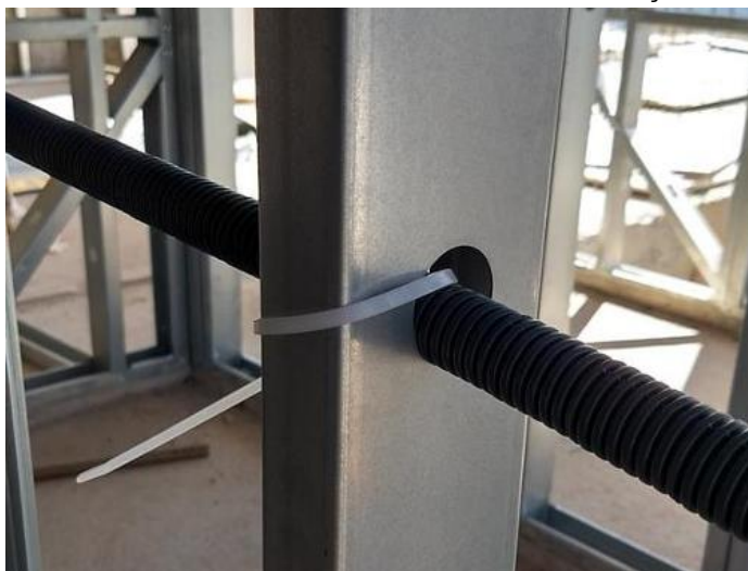
Figura 94 - Eletroduto fixado ao montante com abraçadeira de nylon
