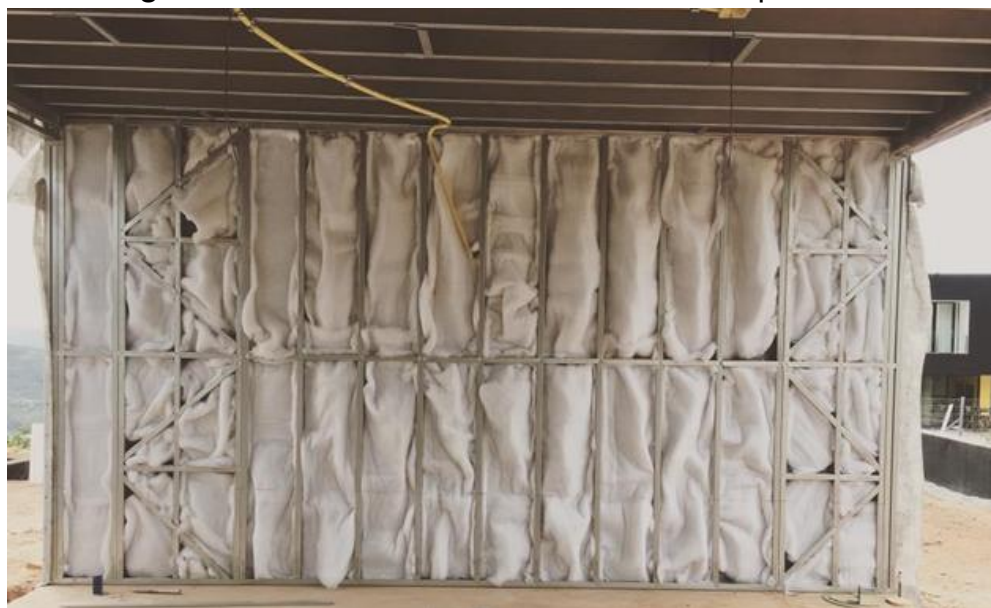
Figura 93 - Parede com isolamento em lã de poliéster
