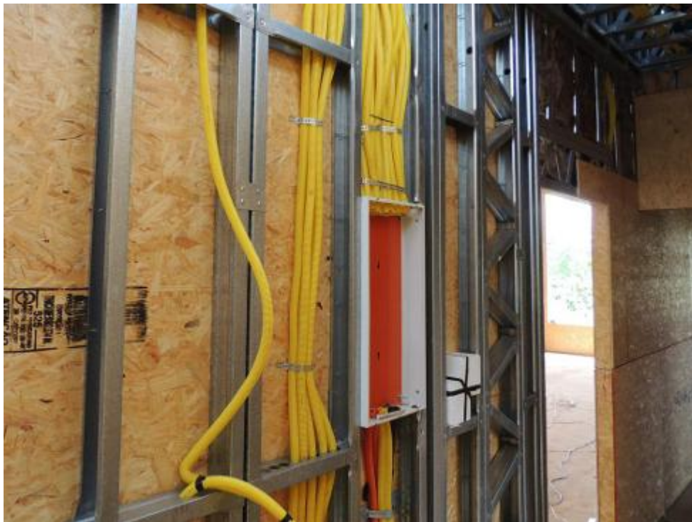
Figura 96 - Quadro de distribuição convencional instalado em parede de LSF
