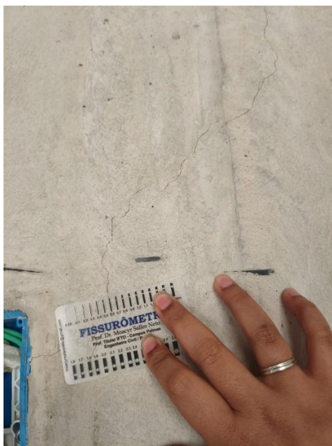
Figura 24 – Mensuração da abertura da fissura (2)
