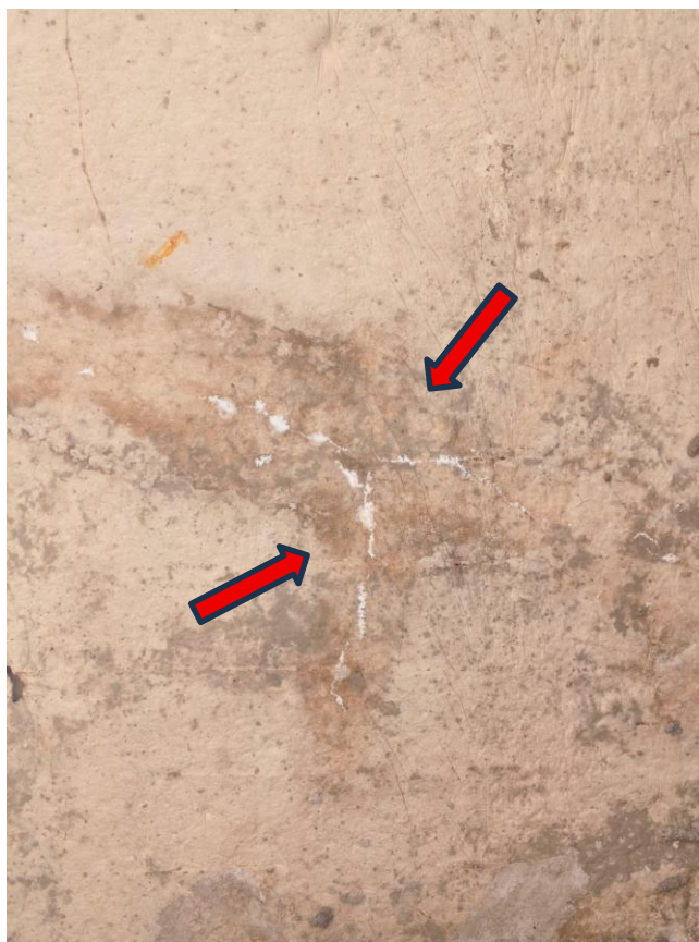
Figura 26 – Mancha de eflorescência (2)
