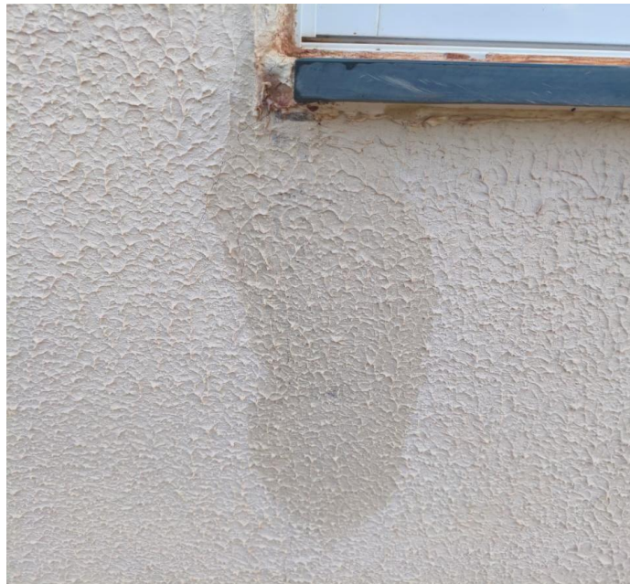
Figura 28 – Mancha de umidade na parte externa
