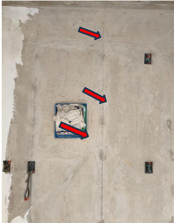
Figura 23 – Fissuração no QDC
