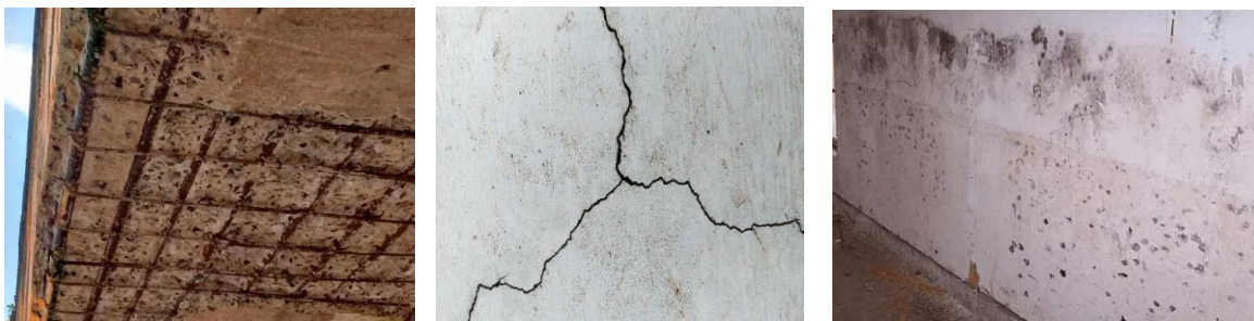
Figura 19 – Manifestações patológicas comuns em estruturas de concreto armado (à esquerda corrosão, ao centro movimentação estrutural e à direita manchas de umidade)
