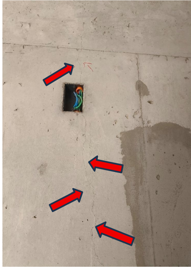
Figura 22 – Fissuração na passagem de eletroduto elétrico
