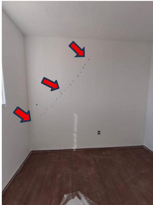
Figura 20 – Fissuração por dilatação térmica
