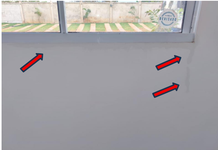
Figura 27 – Mancha de umidade na parte interna
