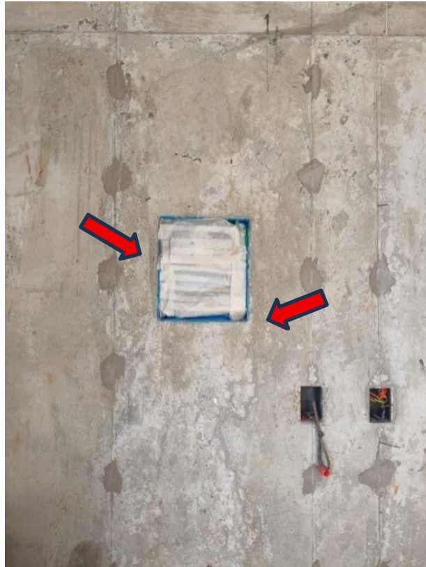
Figura 25 – Mancha de eflorescência (1)
