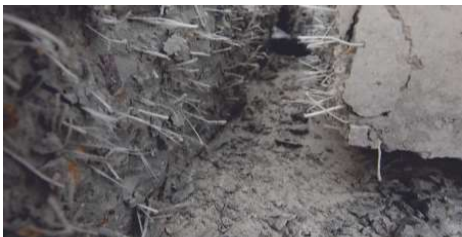
Figura 27 - Concreto com adição de macrofibras polimérica no seu estado endurecido.
