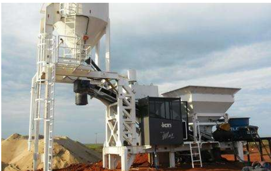
Figura 66 - Centrais dosadora e misturadora de concreto
