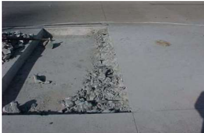
Figura 84 - Defeitos no pavimento causados pelo mal posicionamento das barras de transferência
