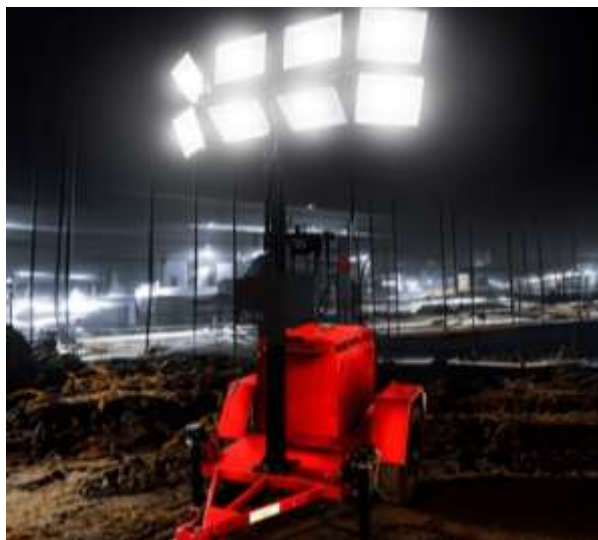
Figura 130 - Equipamento de apoio para iluminação
