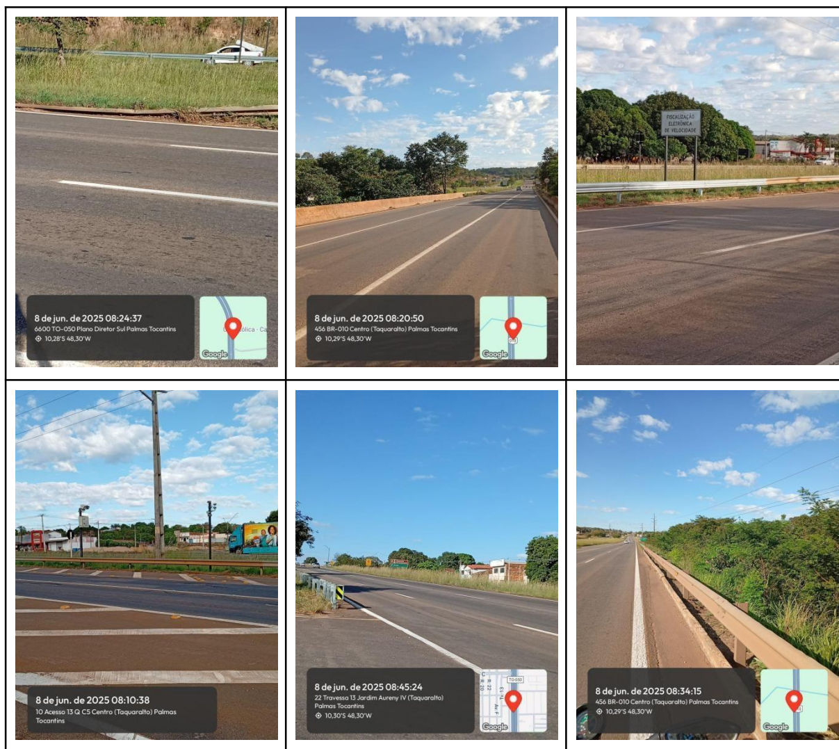
Figura 9: Situações observadas na via, dispositivos auxiliares
