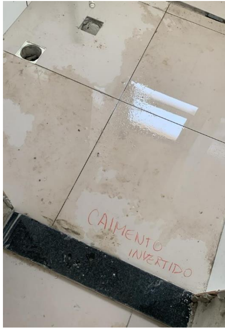
Figura A7 – Caimento invertido.
