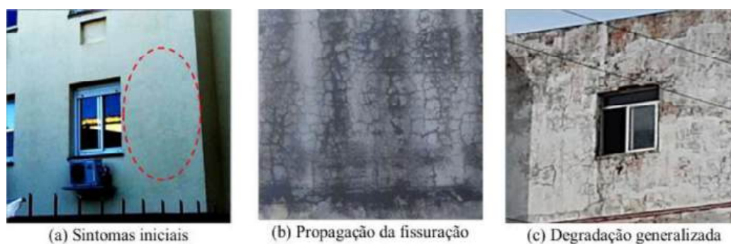
Figura 4 - Exemplo das fases progressivas de degradação.
