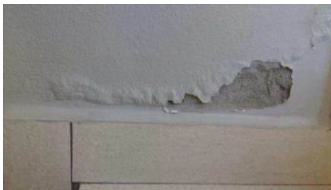
Figura 11 – Infiltração em vedação externa
