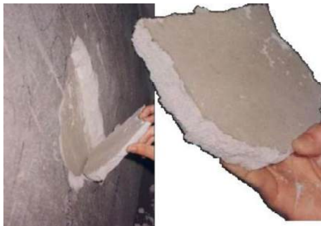
Figura 9 – Descolamento de revestimento argamassado
