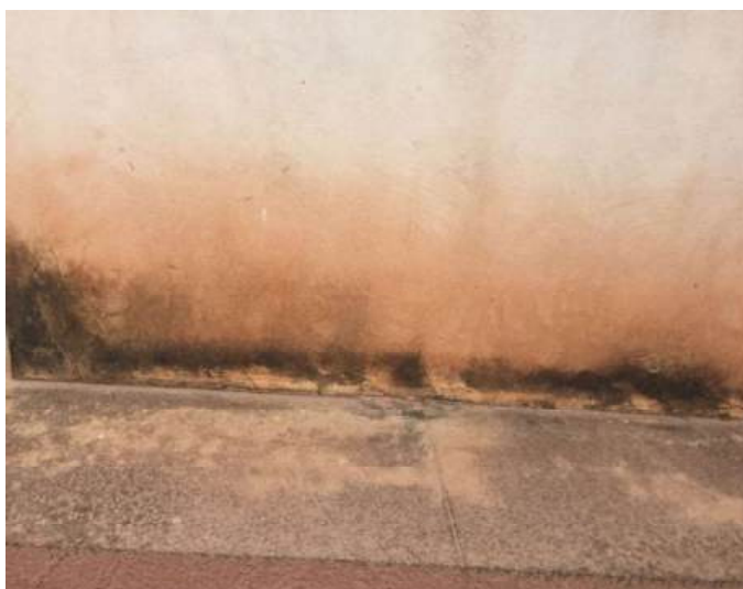
Figura 13 – Sujidade em estrutura de vedação externa
