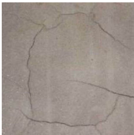
Figura 6 – Fissuração em argamassa com elevada retração
