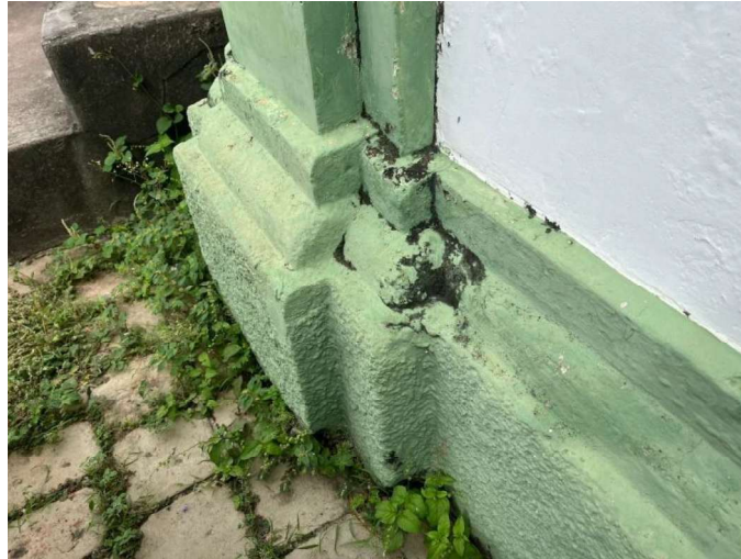
Presença de vegetação, edificação em Natividade – TO
