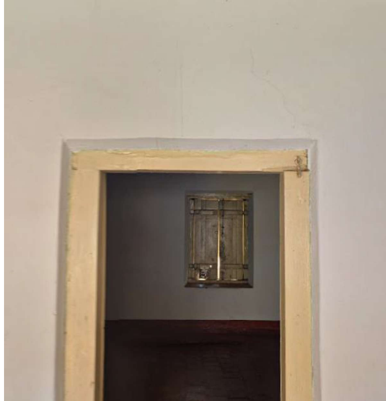
Fissuras, tricas e rachaduras
