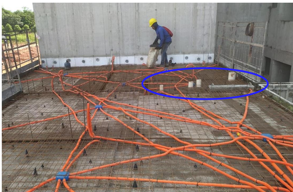
Figura 26 – Elétrica de laje, passantes de laje e shaft
