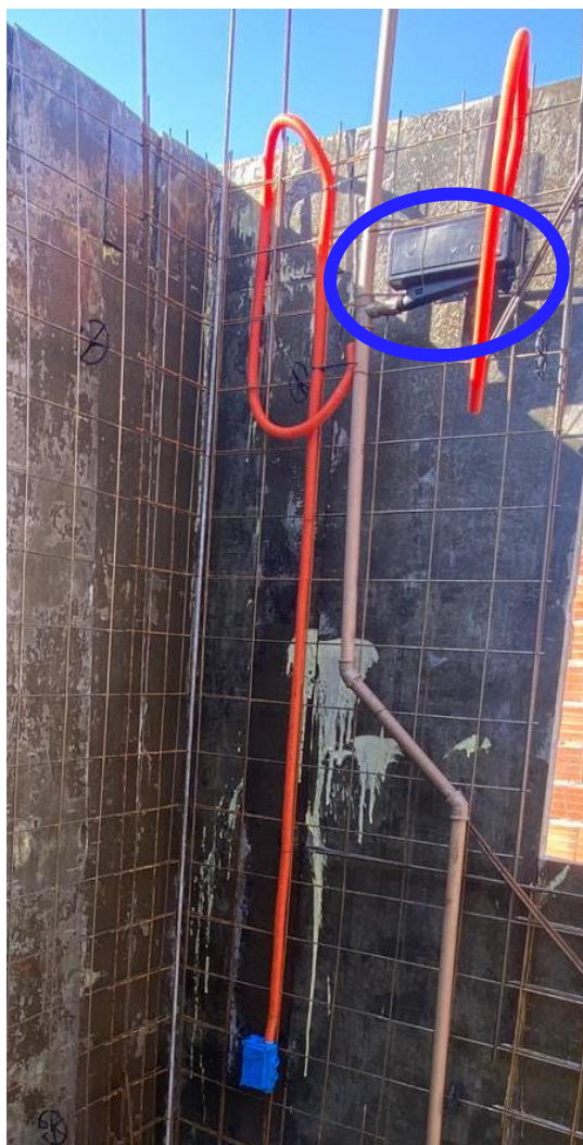
Figura 18 – Drenagem de ar-condicionado
