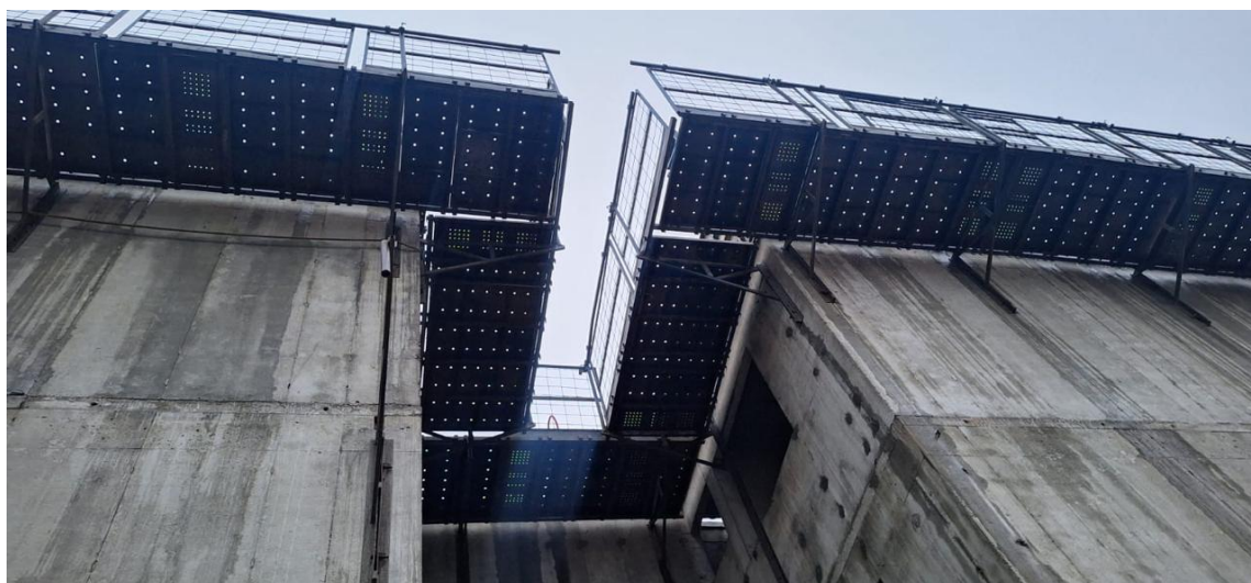
Figura 29 – Plataforma de proteção
