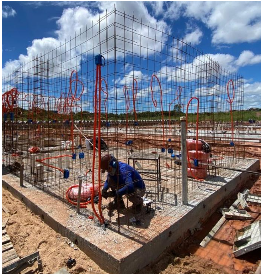
Figura 17 – Elétrica e DVI de parede
