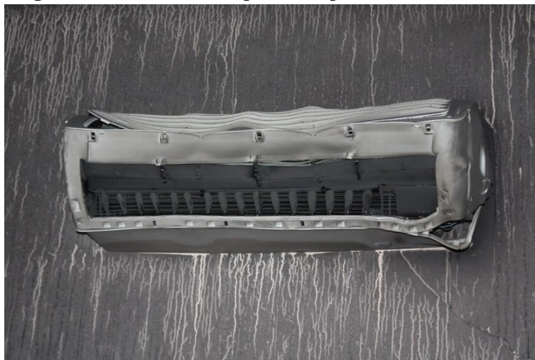
Figura 94 – Unidade evaporadora parcialmente derretida
