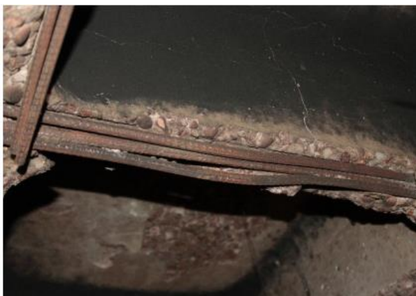
Figura 41 – Deformação permanente das armaduras
