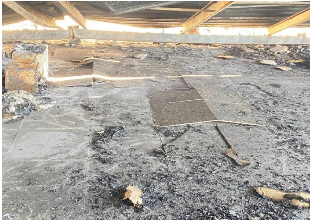
Figura 109 – Deslocamento do revestimento cerâmico
