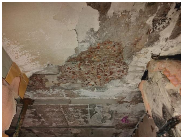
Figura 19 - Efeito spalling no concreto armado
