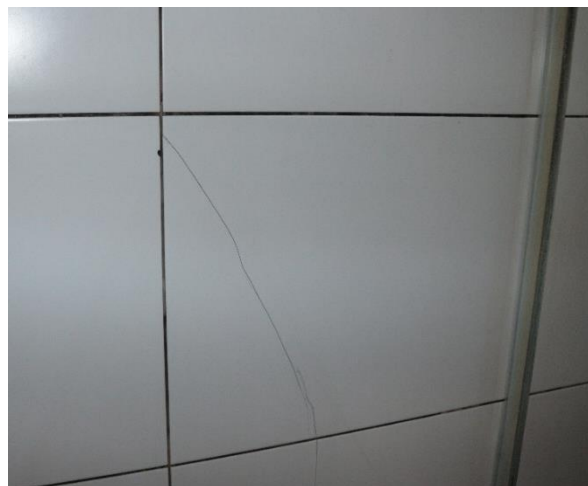
Figura 61 – Fissura no revestimento cerâmico do apartamento afetado
