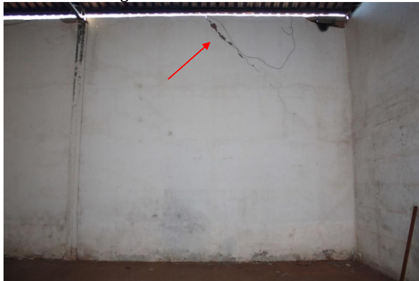
Figura 122 – Trinca na alvenaria
