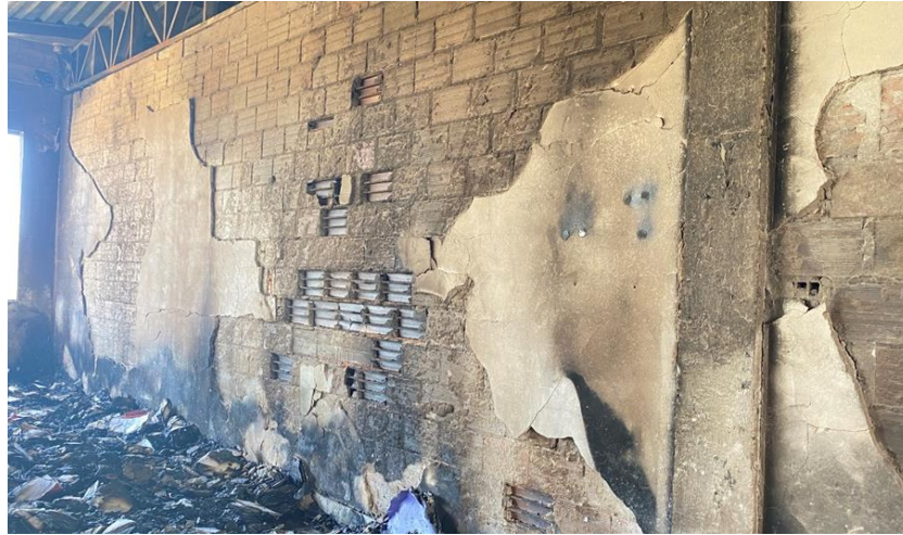
Figura 101 – Desplacamento do revestimento argamassado
