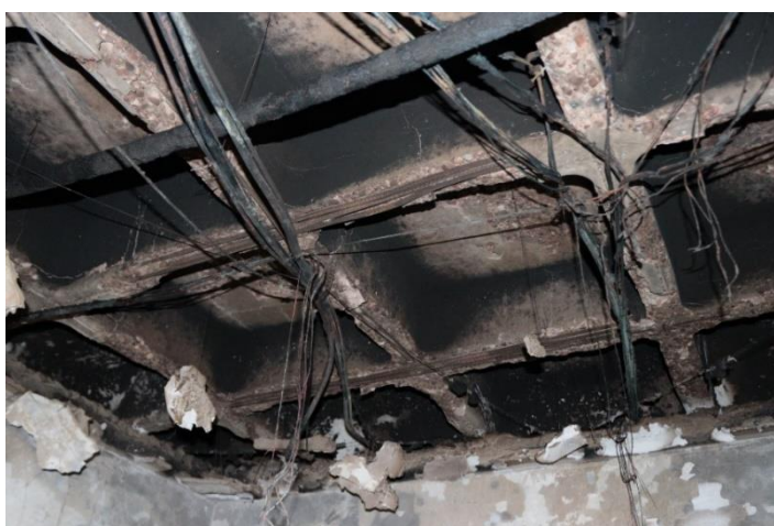
Figura 67 – Comprometimento das instalações elétricas e frigorígenas fixadas na laje
