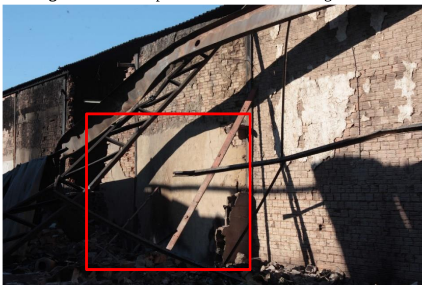
Figura 128 – Desprendimento do reboco argamassado
