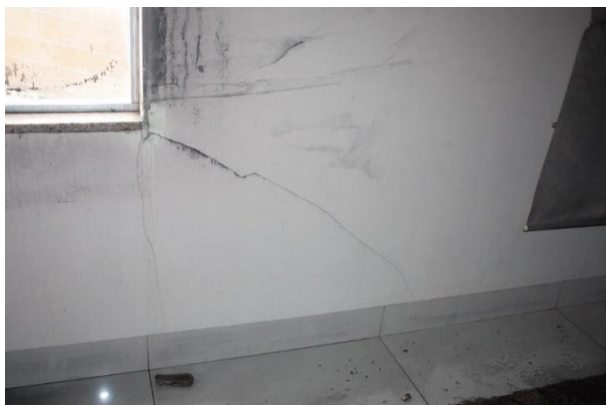
Figura 89 – Fissura a 45° próxima no canto inferior da janela
