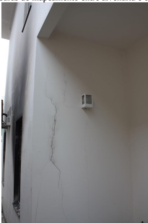
Figura 87 – Fissuras de mapeamento entre alvenaria e o pilar de concreto
