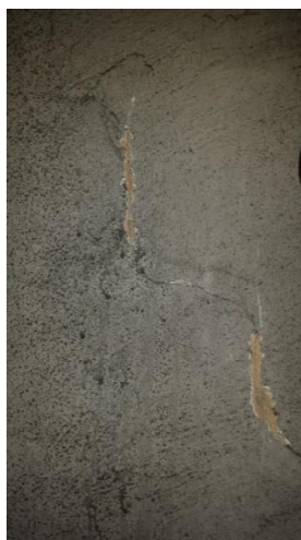
Figura 75 – Vista aproximada da fissuras de mapeamento entre blocos e argamassa de assentamento
