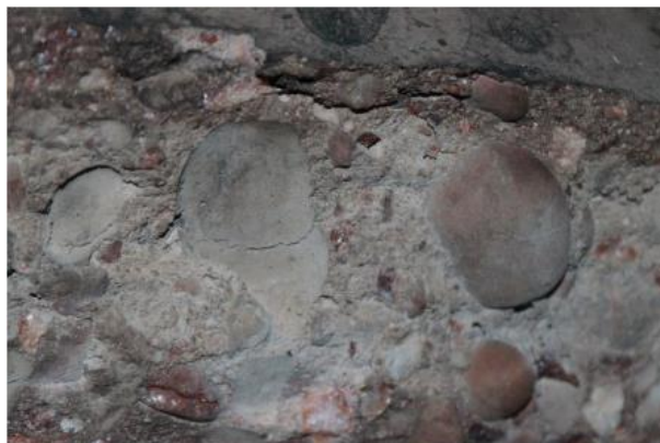
Figura 40 – Vista ampliada da desagregação do concreto da laje
