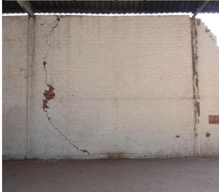
Figura 121 – Trinca provocada pelo arqueamento da alvenaria
