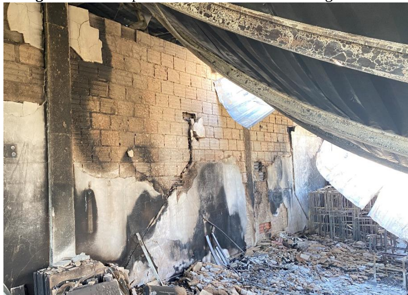
Figura 102 - Desplacamento do revestimento argamassado
