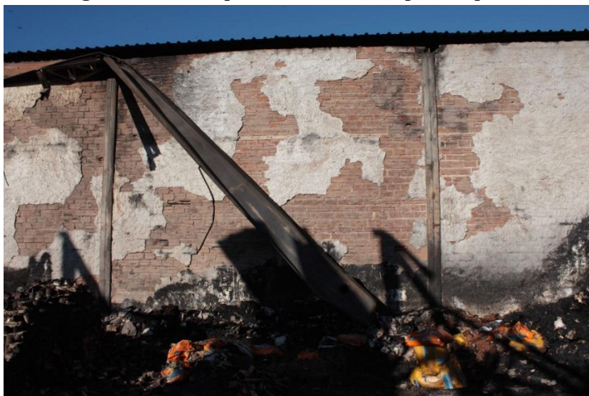
Figura 127 – Desprendimento do chapisco e pintura
