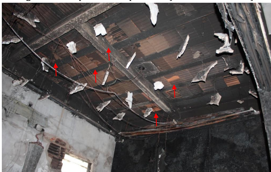
Figura 83 – Rupturas dos septos das lajotas cerâmicas da laje
