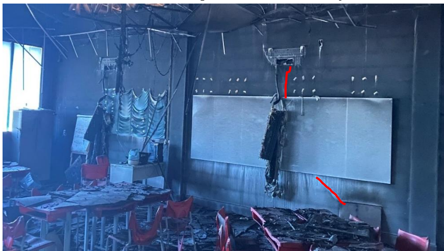
Figura 107 – Possível fissuras de mapeamento das instalações de ar-condicionado
