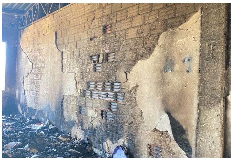
Figura 99 – Rupturas dos septos da alvenaria
