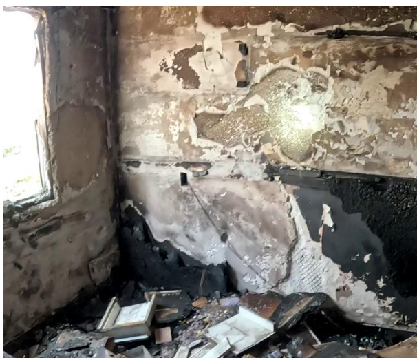
Figura 58 – Deslocamento do revestimento de gesso na suíte
