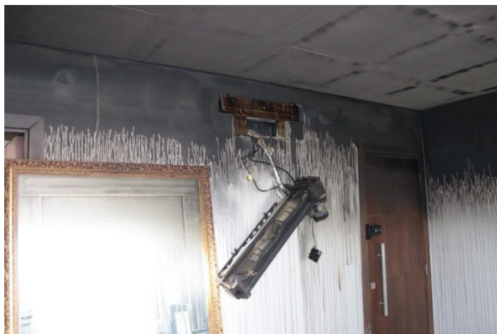
Figura 72 – Comprometimento da unidade evaporadora e instalações frigorígenas
