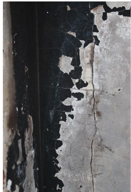
Figura 48 – Vista aproximada da fissura de mapeamento entre alvenaria e o pilar de concreto
