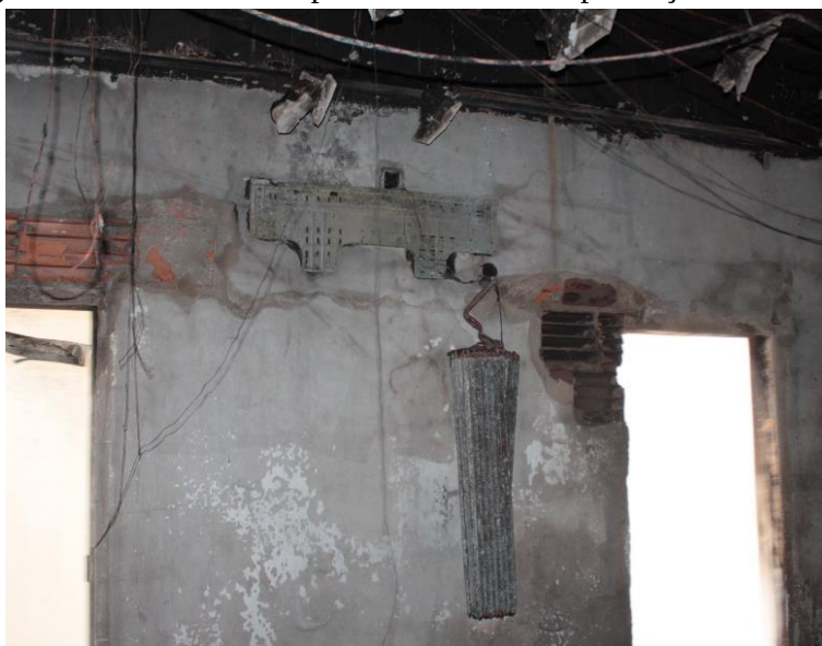
Figura 93 – Unidade evaporadora destruída pela ação do incêndio
