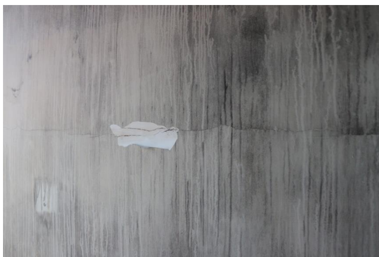
Figura 51 – Fissura de mapeamento de instalações no painel de alvenaria
