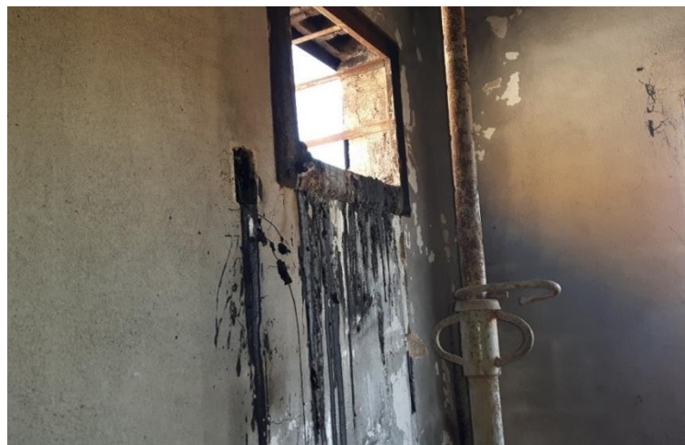
Figura 81 – Danos no aparelho de ar condicionado tipo janela
