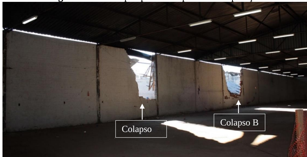
Figura 116 – Colapso parcial da parede de separação
