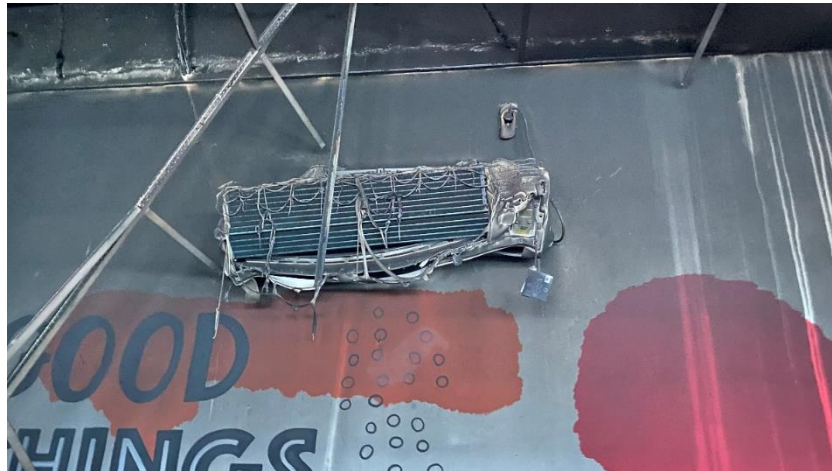
Figura 112 – Unidade evaporadora derretida pelo calor do incêndio
