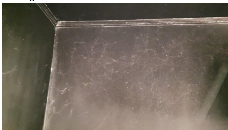
Figura 79 – Fissuras limiformes no revestimento
