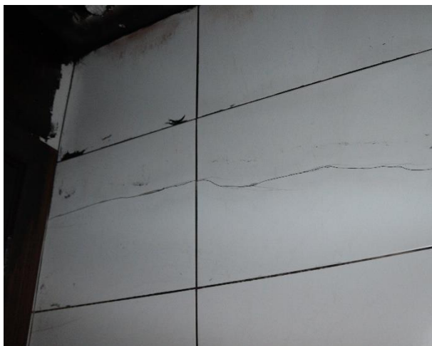
Figura 60 – Fissura no revestimento cerâmico do apartamento afetado
