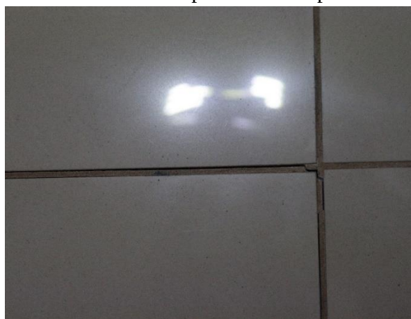
Figura 65 – Fissuras no rejunte do revestimento do apartamento superior
