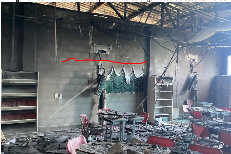
Figura 105 – Fissura de mapeamento da argamassa de assentamento
