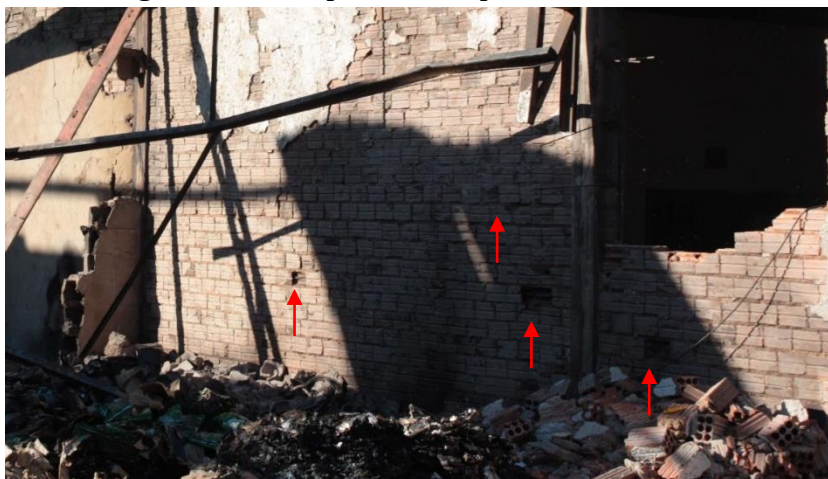
Figura 125 – Ruptura dos septos na face externa
