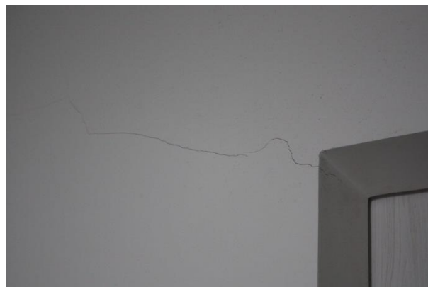
Figura 90 – Fissura a 45° próxima no canto superior da porta
