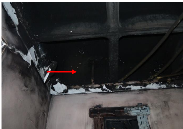
Figura 68 – Comprometimento das instalações hidráulicas fixadas na laje
