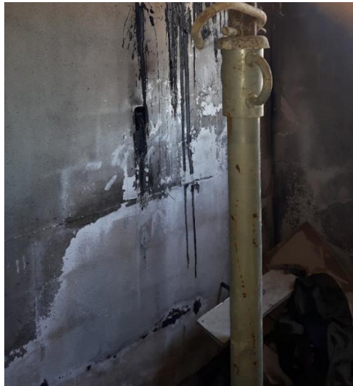
Figura 73 – Fissuras de mapeamento na argamassa de assentamento
