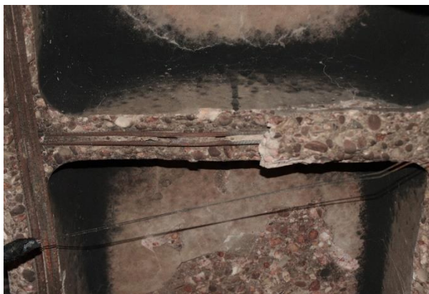
Figura 43 – Efeito spalling do concreto
