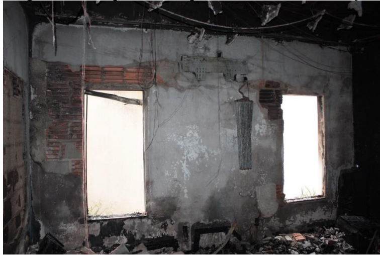
Figura 84 – Ruptura dos septos da alvenaria de vedação
