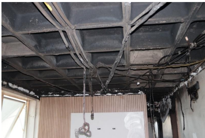
Figura 66 – Comprometimento das instalações elétricas e frigorígenas fixadas na laje
