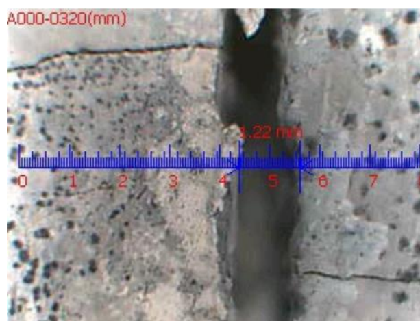
Figura 49 – Leitura da abertura da fissura no painel de alvenaria
