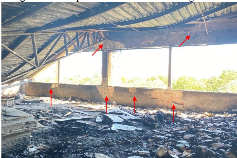
Figura 103 - Deslocamento do revestimento argamassado
