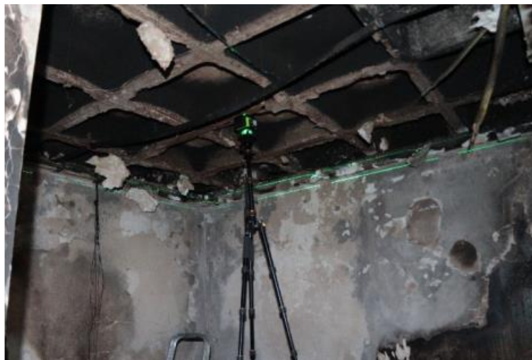
Figura 45 – Aferição da deformação residual da estrutura da laje de cobertura do apartamento sinistrado
