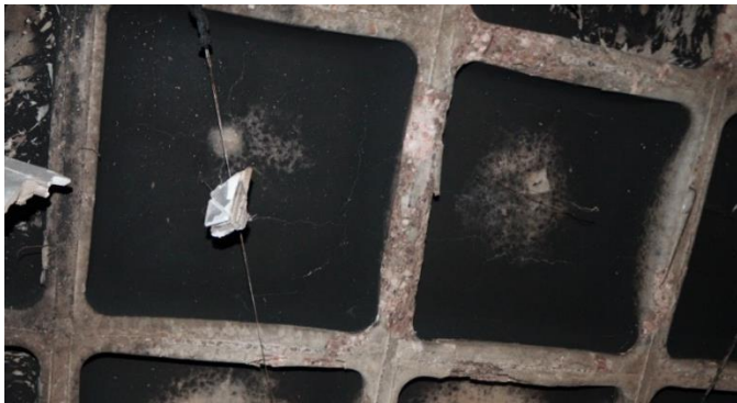
Figura 38 – Presença de fissuras na laje
