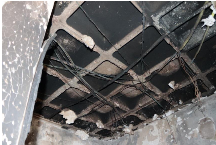
Figura 35 – Condições da laje nervurada após ação do incêndio
