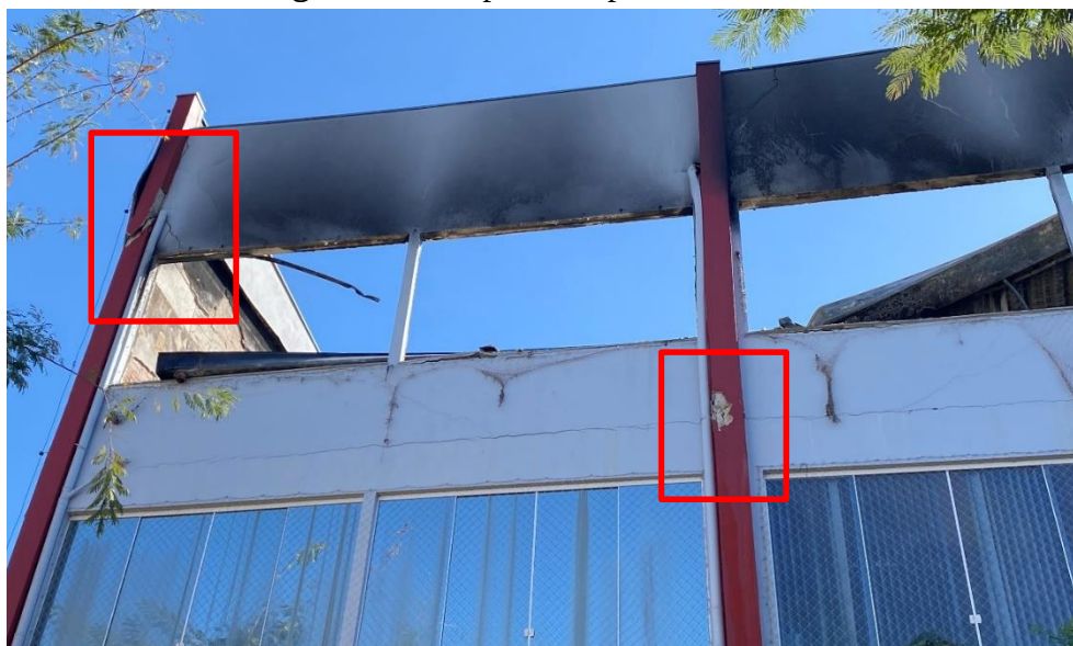
Figura 95 – Ruptura no pilar da fachada
