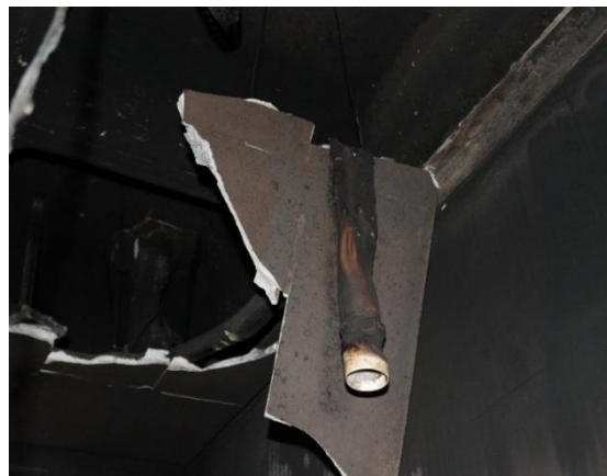
Figura 69 – Comprometimento das instalações sanitárias fixadas na laje
