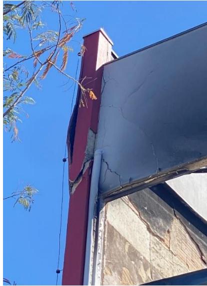
Figura 96 – Ruptura no pilar da fachada
