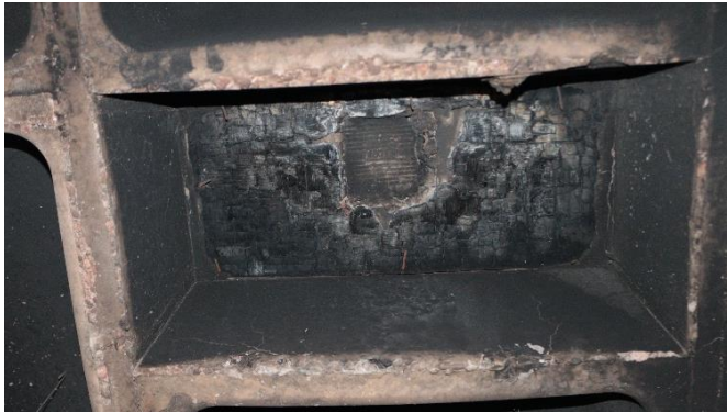
Figura 37 – Deterioração da mesa da laje
