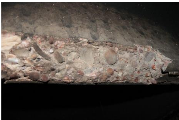
Figura 39 – Desagregação do concreto da laje
