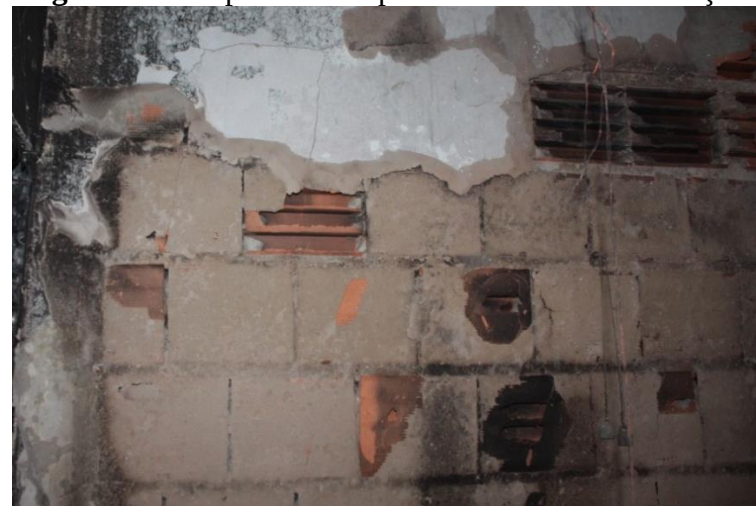
Figura 86 – Ruptura dos septos da alvenaria de vedação
