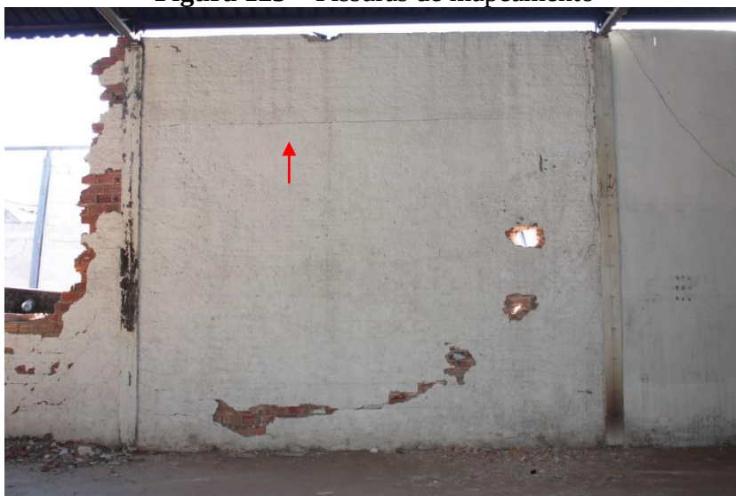
Figura 123 – Fissuras de mapeamento
