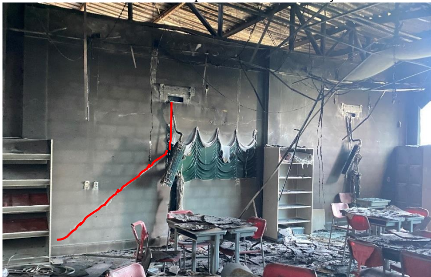
Figura 108 – Possível fissuras de mapeamento das instalações de ar-condicionado
