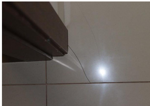
Figura 63 – Fissuras no revestimento cerâmico do apartamento superior
