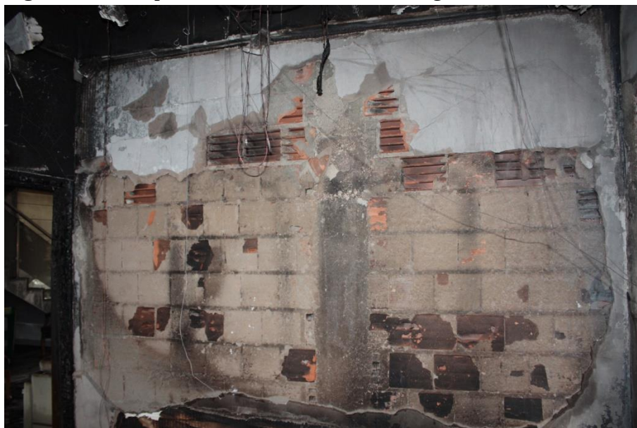
Figura 91 – Desplacamento do revestimento argamassado da alvenaria
