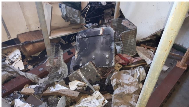
Figura 82 – Condições do aparelho tipo janela pós incêndio
