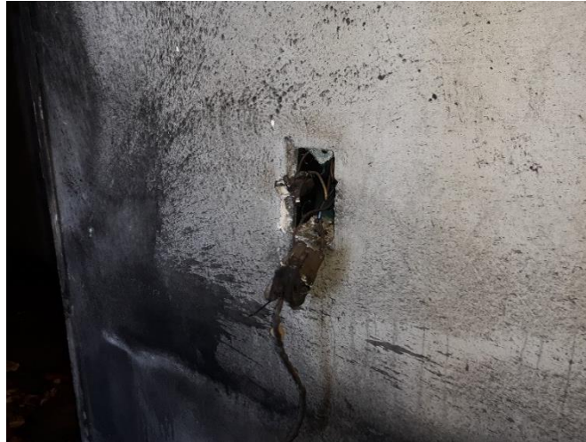
Figura 80 – Tomada danificada pela ação do incêndio
