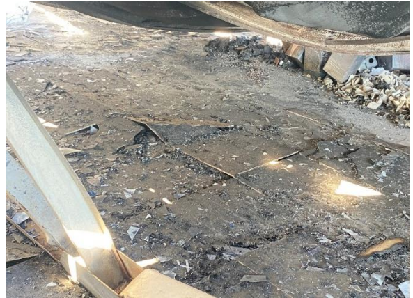
Figura 110 – Deslocamento do revestimento cerâmico
