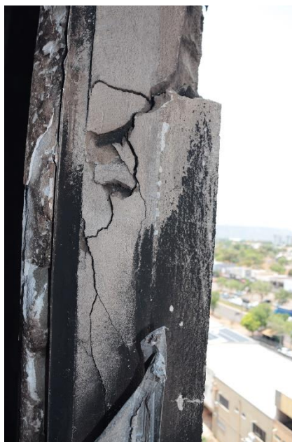
Figura 54 – Degradação do revestimento na proximidade da janela da suíte
