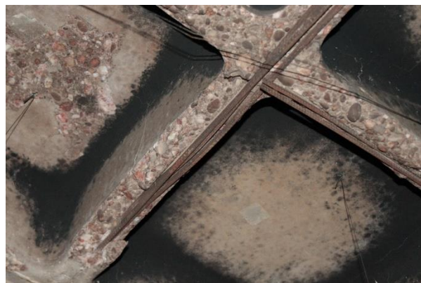
Figura 44 – Efeito spalling do concreto
