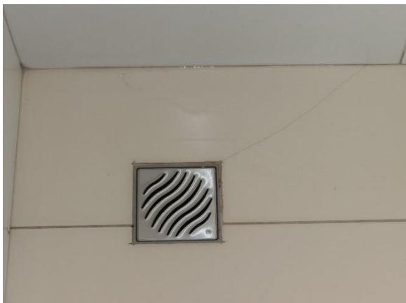
Figura 62 – Fissuras no revestimento cerâmico do apartamento superior
