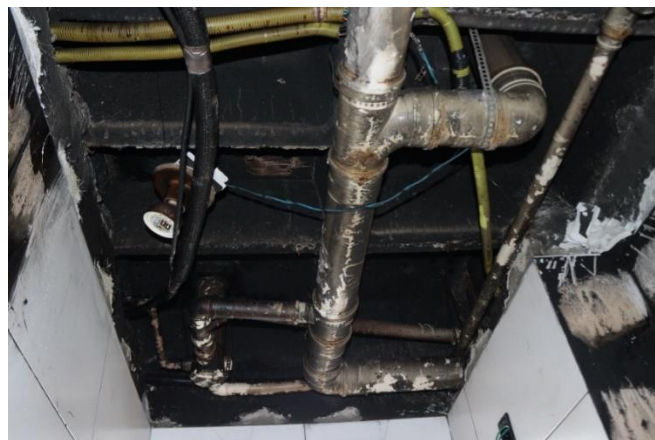
Figura 71 – Comprometimento das instalações hidráulicas, sanitárias, elétricas e frigorígenas fixadas na laje
