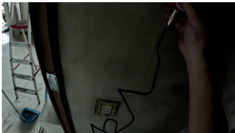
Figura 52 – Fissura de mapeamento de instalações no painel de alvenaria
