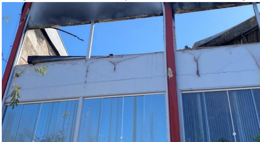
Figura 97 – Fissura de dilatação térmica entre alvenaria e viga
