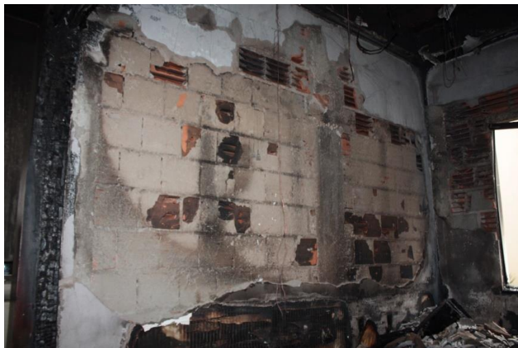
Figura 85 – Ruptura dos septos da alvenaria de vedação
