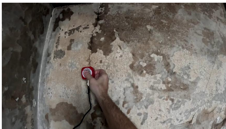
Figura 50 – Fissura de mapeamento de instalações no painel de alvenaria
