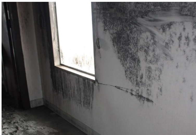
Figura 88 – Fissura horizontal no canto inferior da janela
