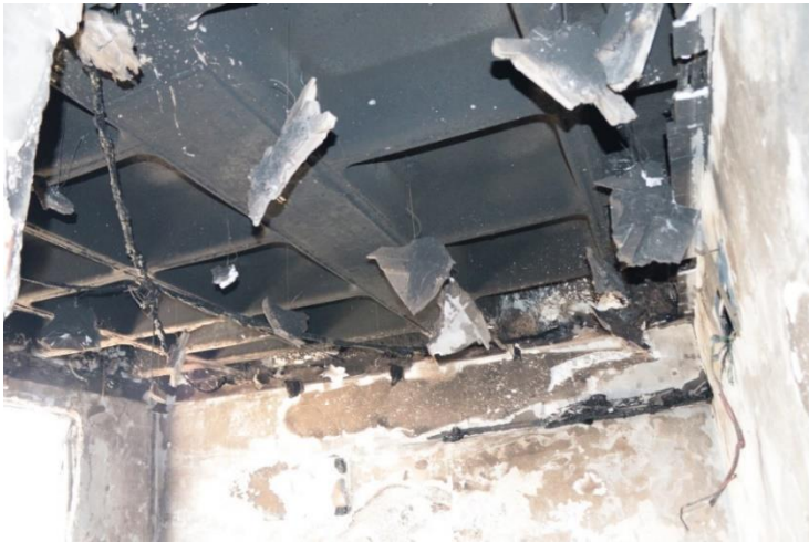
Figura 34 – Resquícios do forro de gesso
