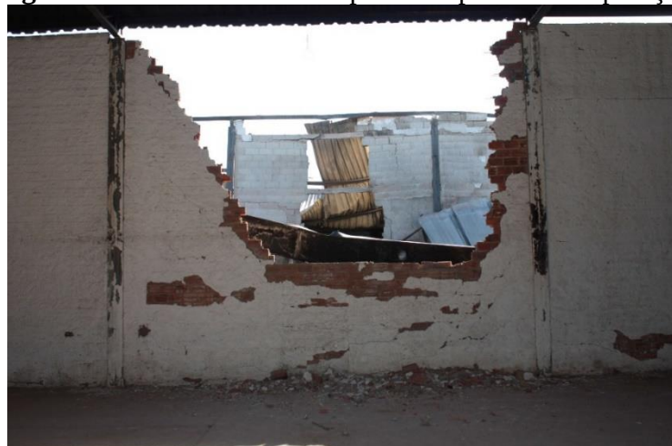
Figura 118 – Detalhe do Colapso B da parede de separação
