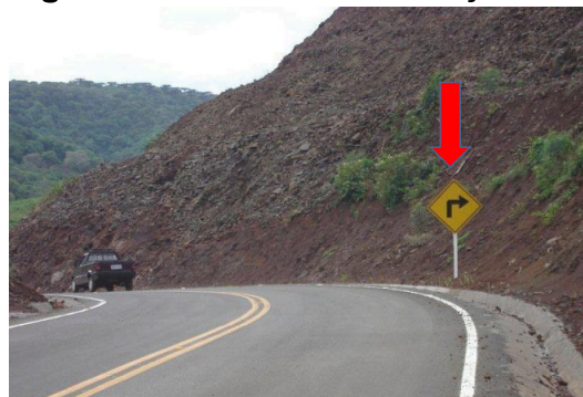
Figura 18 - Falha na sinalização
