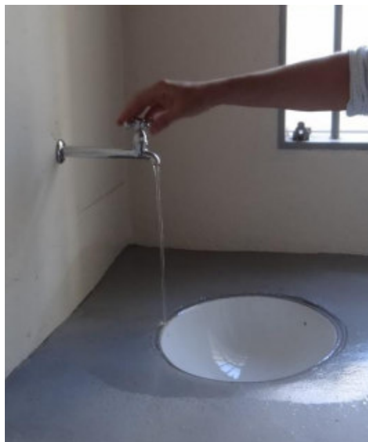
Figura 20 - Falha na execução
