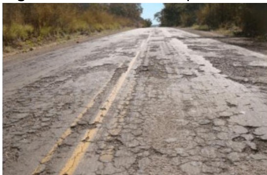
Figura 17 - Problemas no pavimento
