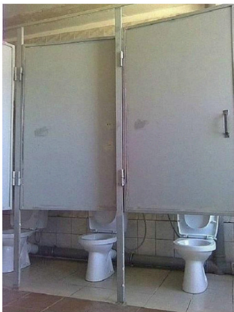
Figura 19 - Falha na execução
