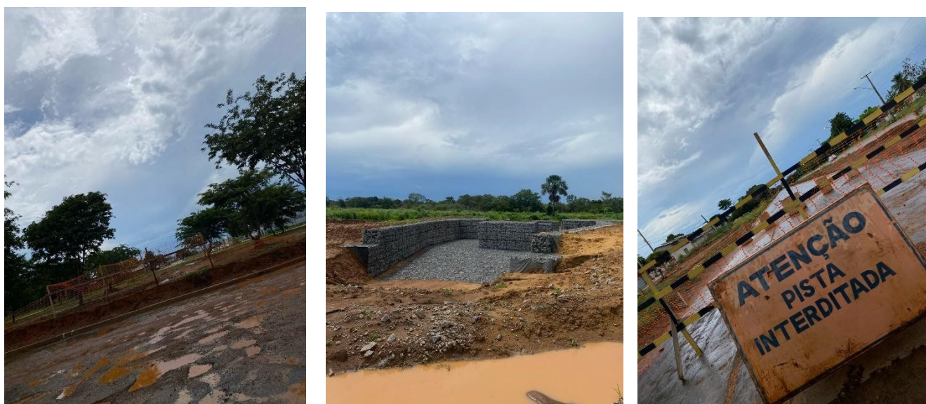
Figuras 1, 2 e 3: Obra paralisada por dificuldades ambientais e orçamentárias.
