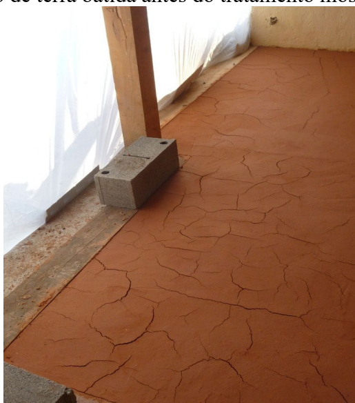
Figura 13 - Piso de terra batida antes do tratamento mostrando as fissuras
