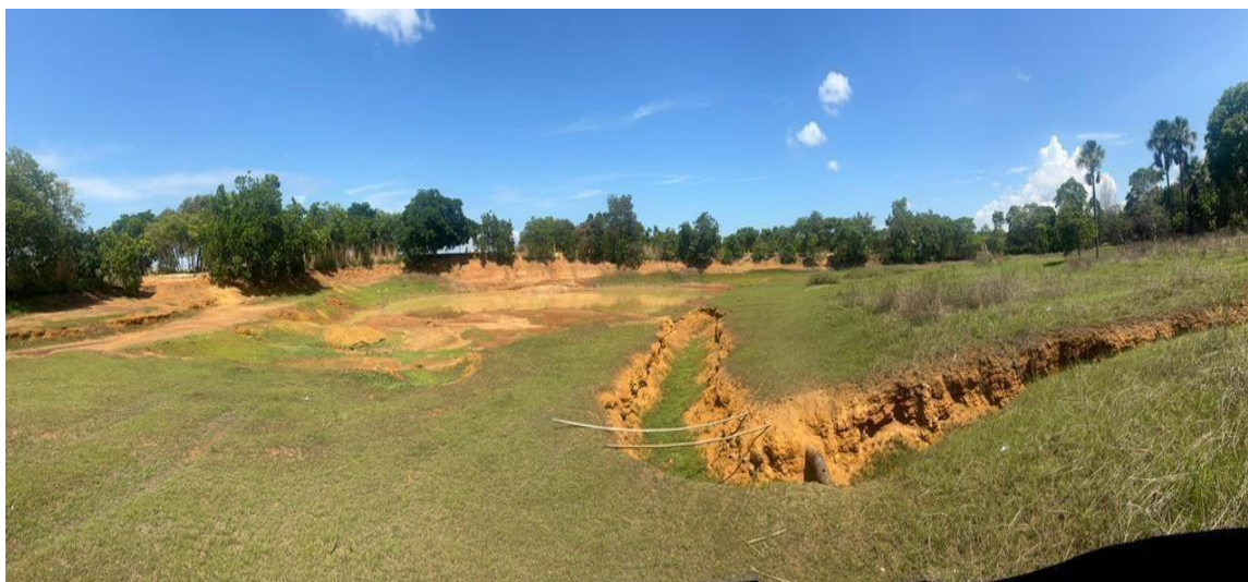
Figura 3.7 – Área de jusante com evidências de erosão no período seco (setembro/2025)
