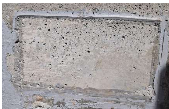
Figura 33 - Face bloco traço 30%.
