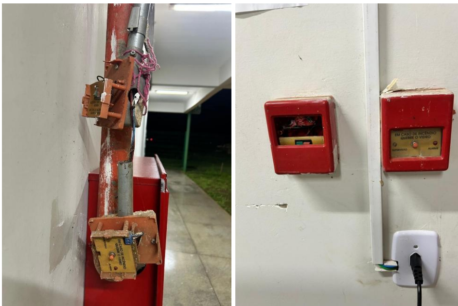
Figura 33 – Alarmes de incêndio e Acionadores de bomba de incêndio
