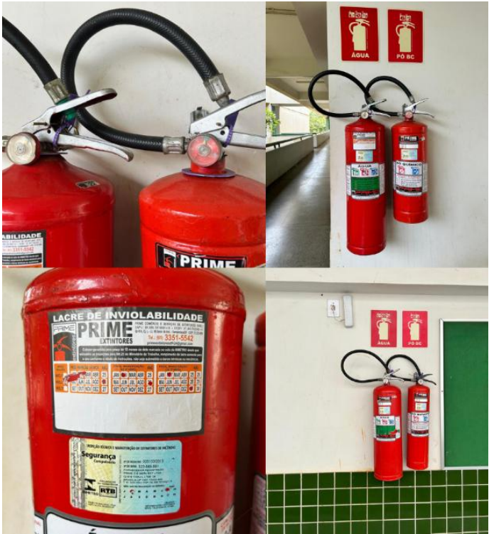
Figura 36 – Condição dos extintores
