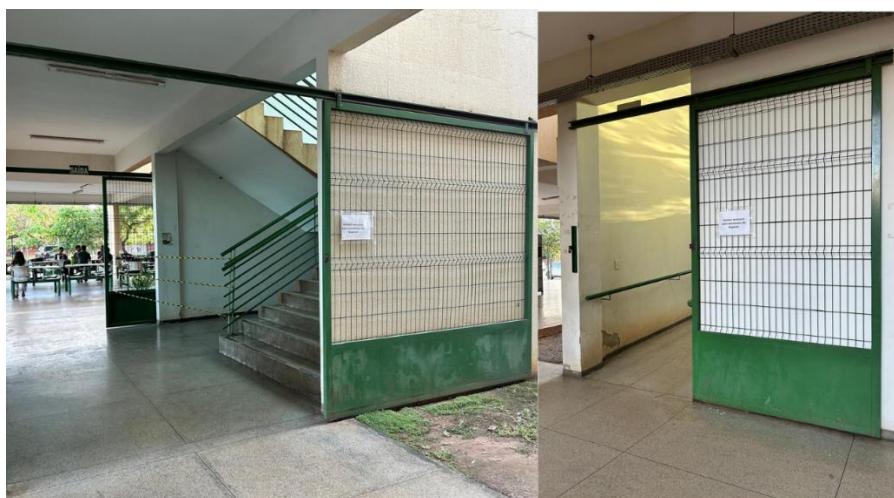
Figura 31 – Obstrução escadas e rampa
