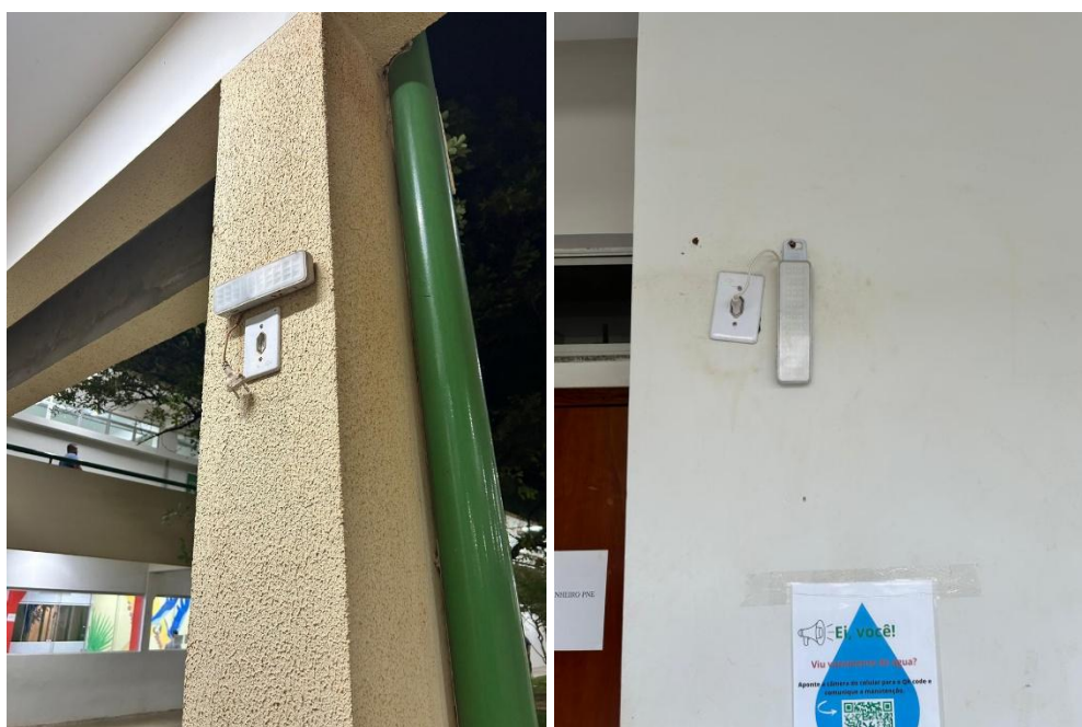
Figura 32 – Iluminação de emergência
