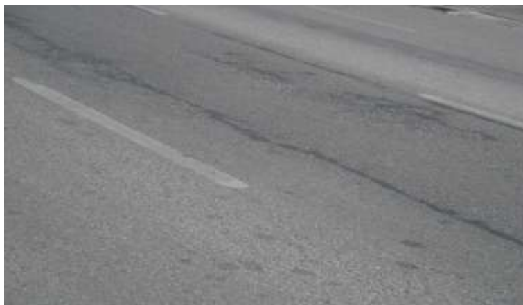
Figura 6. Degradação por exsudação
