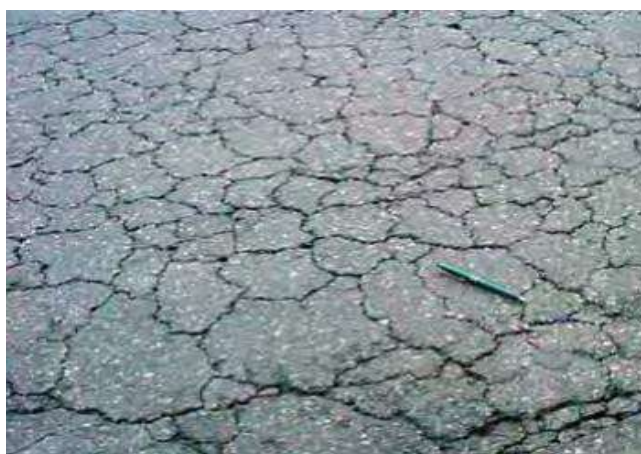
Figura 7. Trinca tipo couro de jacaré
