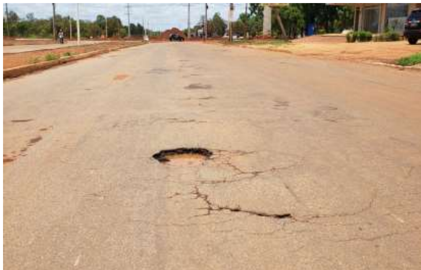
Figura 18 - Exemplo de panela ou buraco. Local: Avenida LO-12, Palmas-TO.
