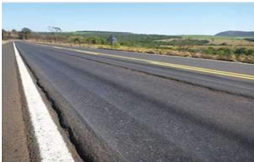
Figura 13 - Exemplo de afundamento.
