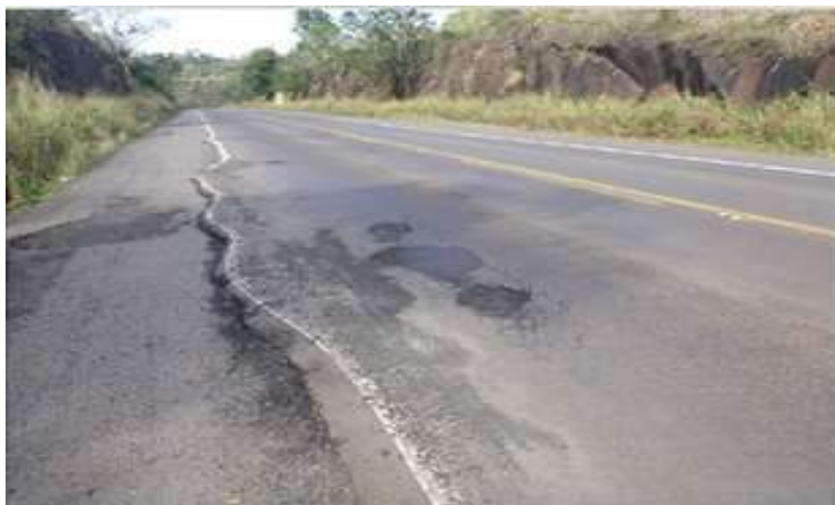
Figura 15 - Exemplo de escorregamento.
