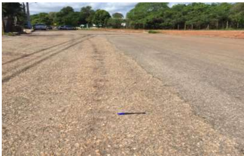
Figura 17 - Exemplo de desgaste. Local: Avenida NS-08, Palmas-TO.
