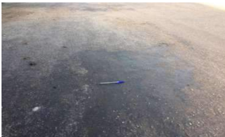
Figura 16 - Exemplo de exsudação. Local: Avenida NS-08, Palmas-TO.
