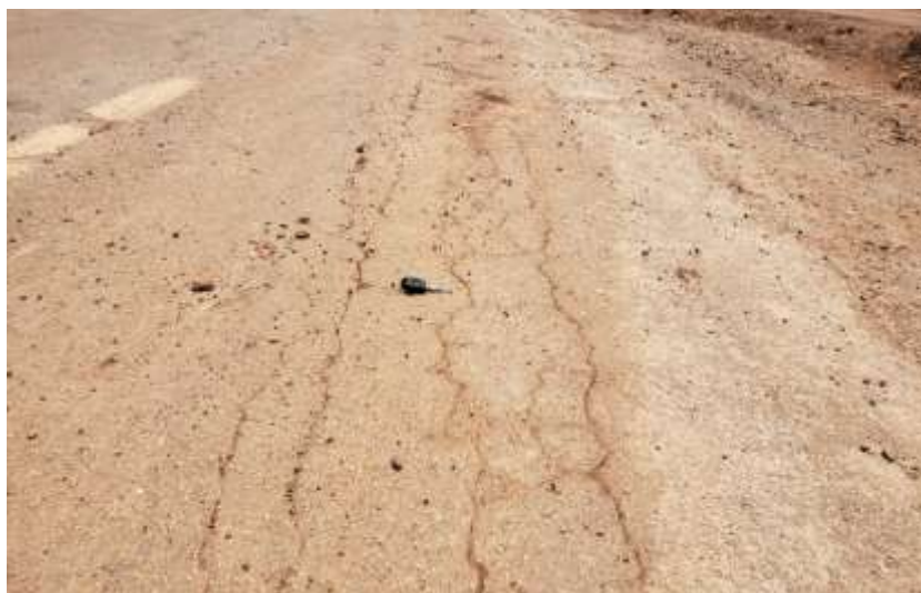
Figura 12 - Exemplo de trincas longitudinais. Local: Avenida NS-10, Palmas-TO.
