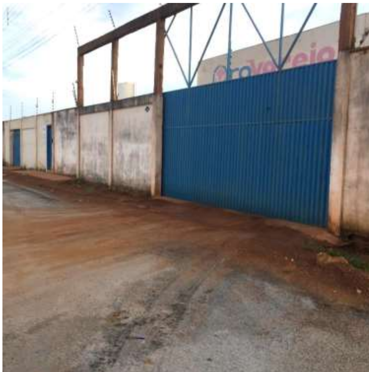
Figura 39 - Desagregação no pavimento.
