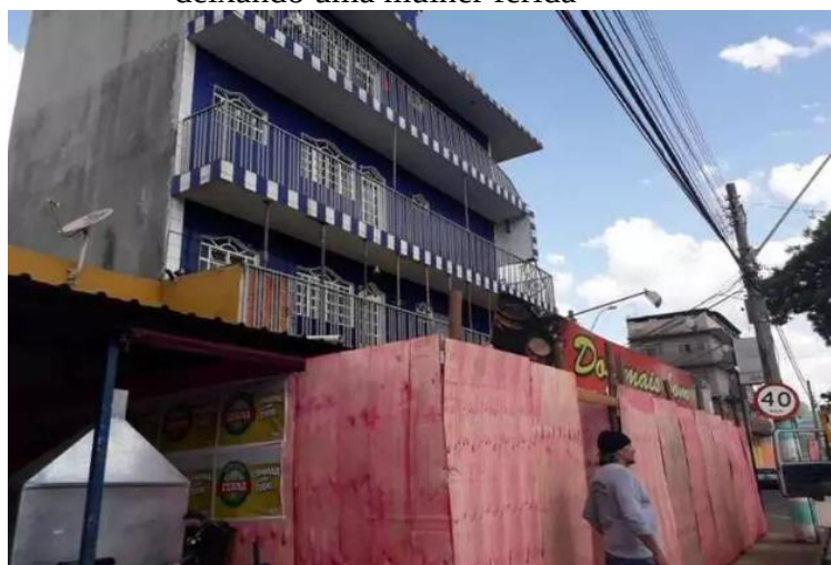
Figura 7 - Em Taguatinga Sul, a varanda do terceiro andar de um edifício ruiu no sábado, deixando uma mulher ferida
