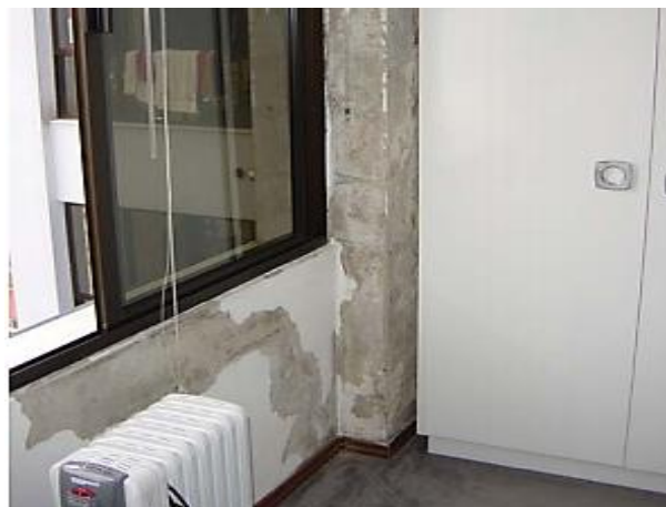
Figura 9 - Descolamento de revestimento com pulverulência
