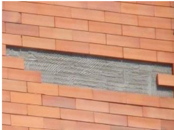
Figura 8 - Descolamento de placas cerâmicas
