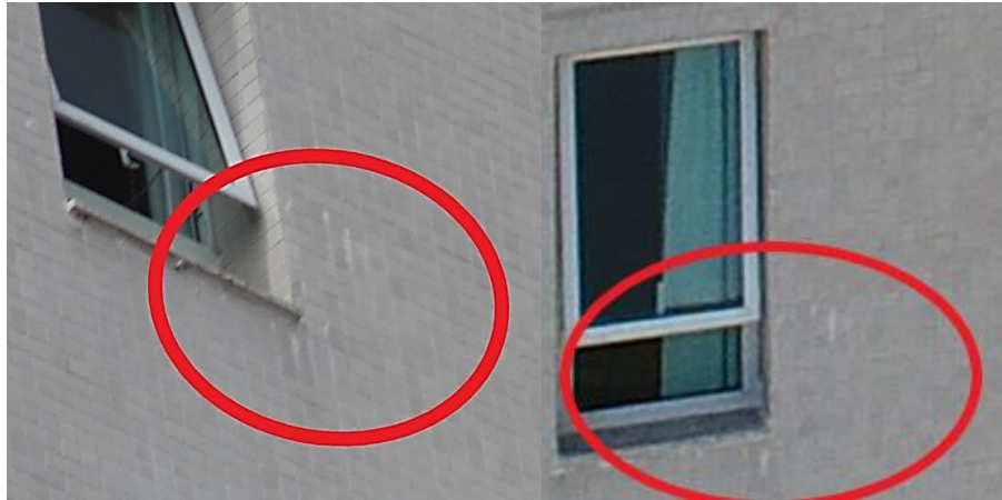
Figura 76 - Eflorescência na fachada lateral esquerda - máquina tradicional (esq.) e com drone (dir.)
