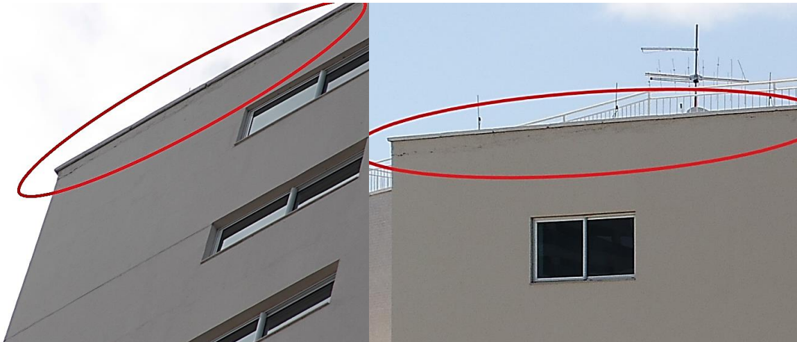
Figura 80 – Dilatação térmica diferencial com ruptura da pintura na fachada lateral esquerda - máquina tradicional (esq.) e com drone (dir.)
