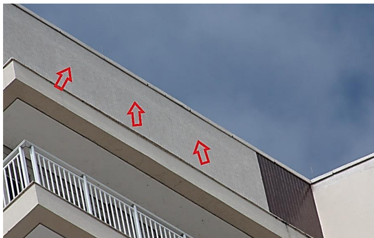
Figura 73 – Eflorescência na fachada lateral esquerda (máquina tradicional)
