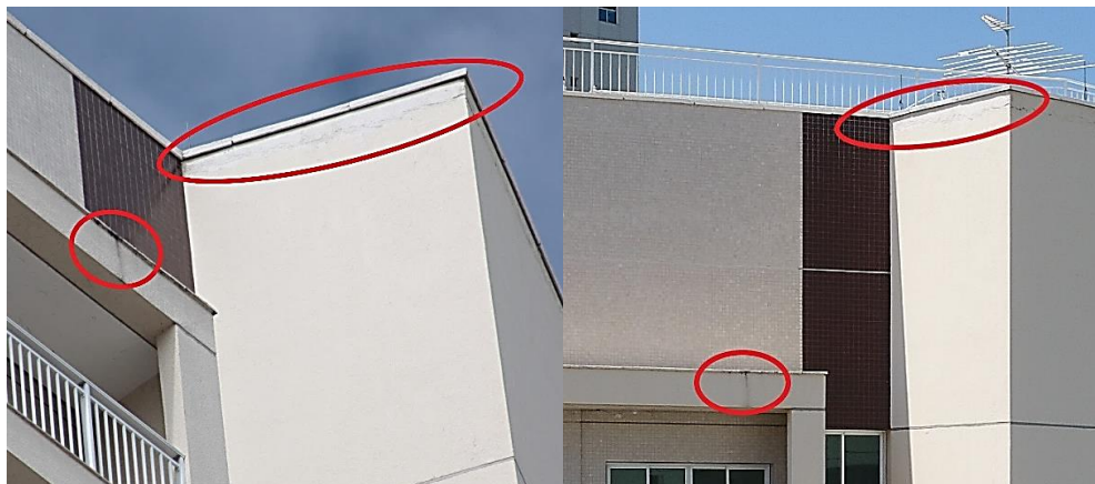
Figura 81 – Sujidade e dilatação térmica diferencial na fachada lateral esquerda - máquina tradicional (esq.) e com drone (dir.)
