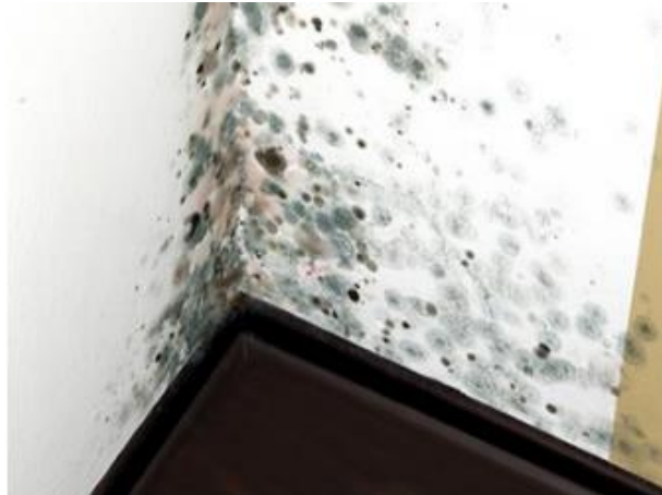
Figura 5 - Bolor em revestimento
