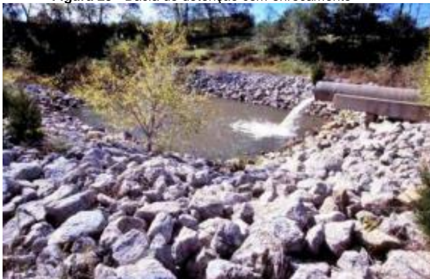
Figura 25 - Bacia de retenção com enrocamento
