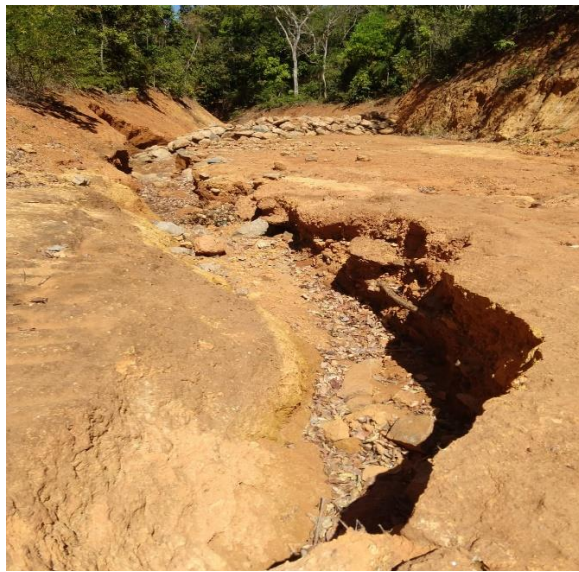
Figura 16 - Ravinas provocadas pela erosão hídrica
