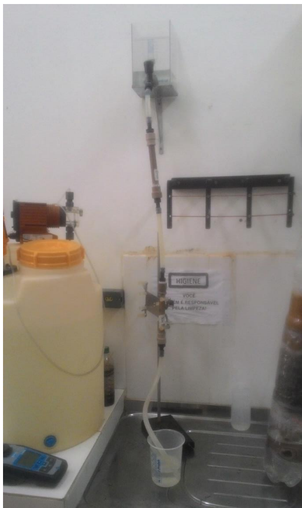
Figura 15 - Sistema de filtração de águas cinzas com filtro de areia e carvão ativado em série Fonte: Autor (2019)
