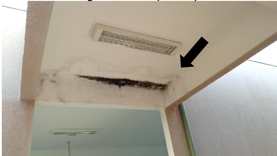
Figura 26 - Infiltração na laje
