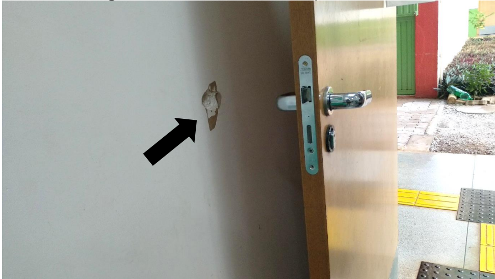
Figura 24 - Parede danificada por falta de batedor
