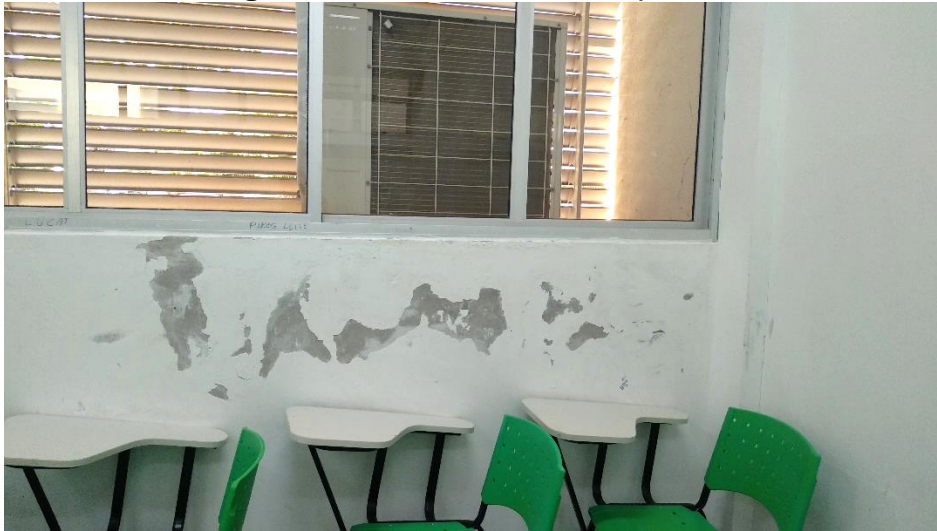
Figura 33 - Descolamento da pintura
