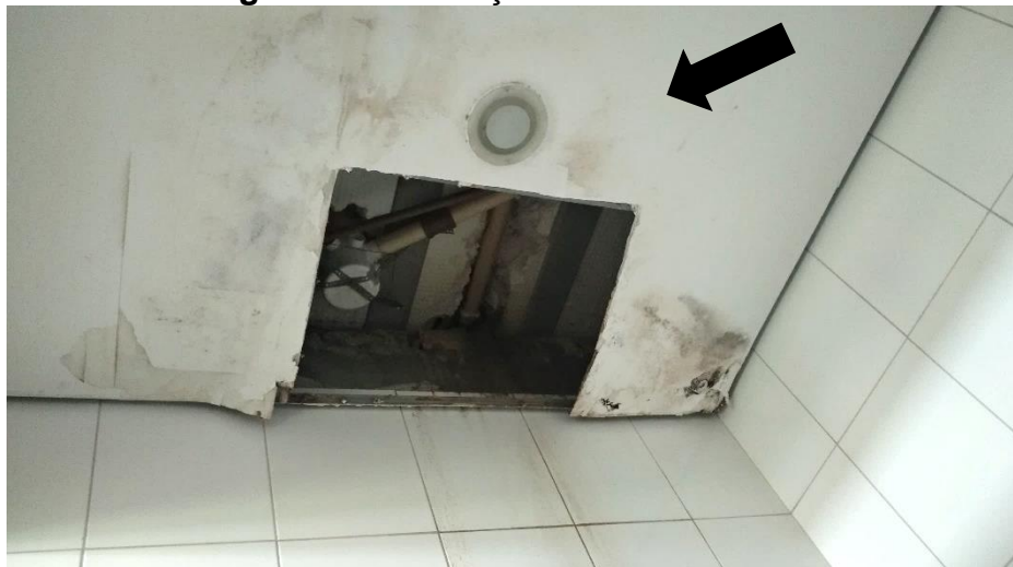
Figura 25 - Infiltração no banheiro PCD
