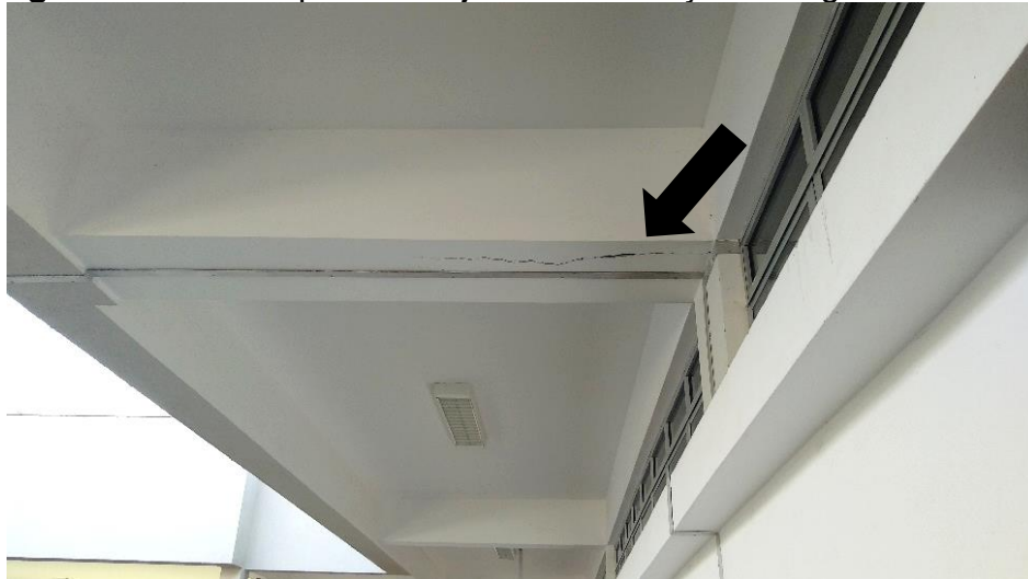
Figura 12 – Trinca próximo à junta de dilatação na viga do corredor
