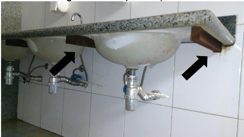
Figura 29 - Oxidação de suporte metálico
