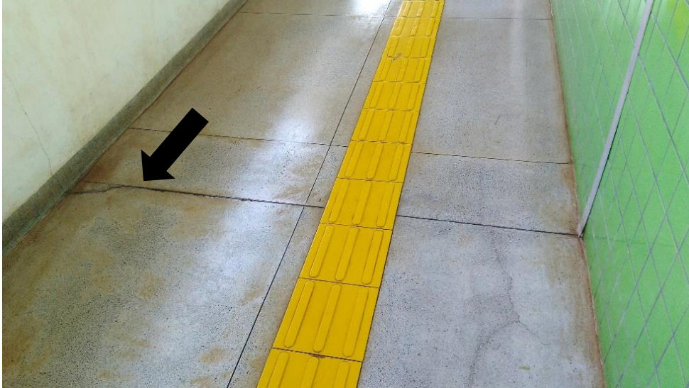
Figura 13 - Abertura da junta de dilatação no piso do corredor
