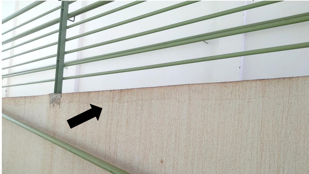
Figura 22 - Fissura em toda a extensão da rampa
