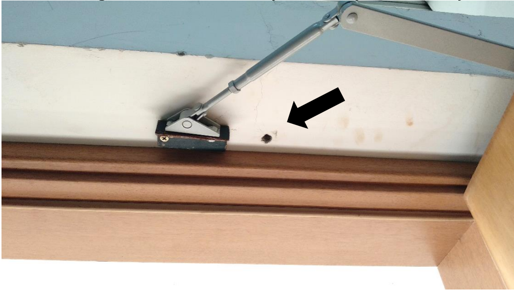
Figura 30 - Erro na instalação dos braços de articulação
