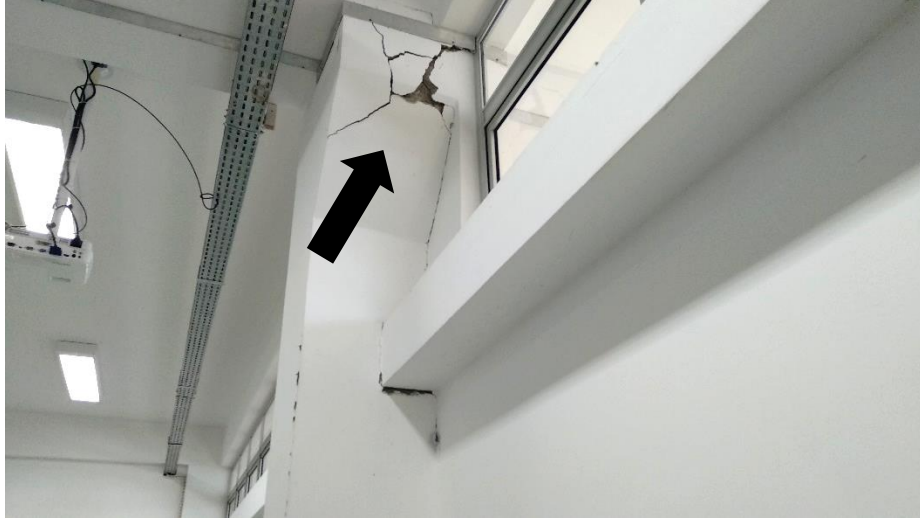
Figura 16 - Esmagamento do concreto (área interna – sala de aula)
