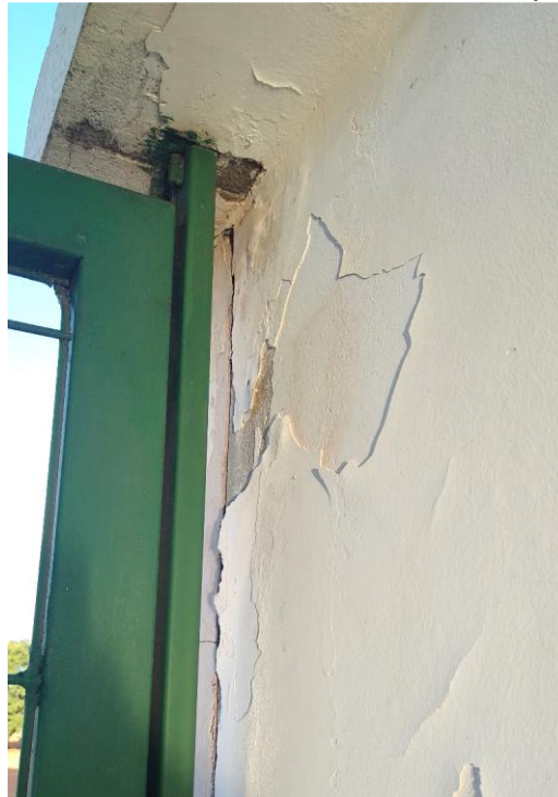
Figura 34 - Inconformidade entre substrato e perfil metálico
