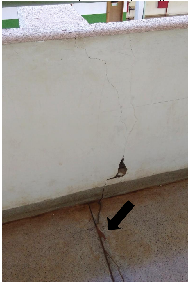
Figura 14 - Abertura da junta de dilatação no guarda corpo
