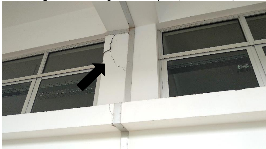
Figura 17 - Esmagamento do pilar (área externa)
