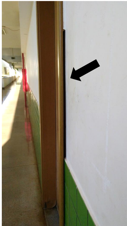
Figura 19 - Orifício entre alizar e revestimento cerâmico
