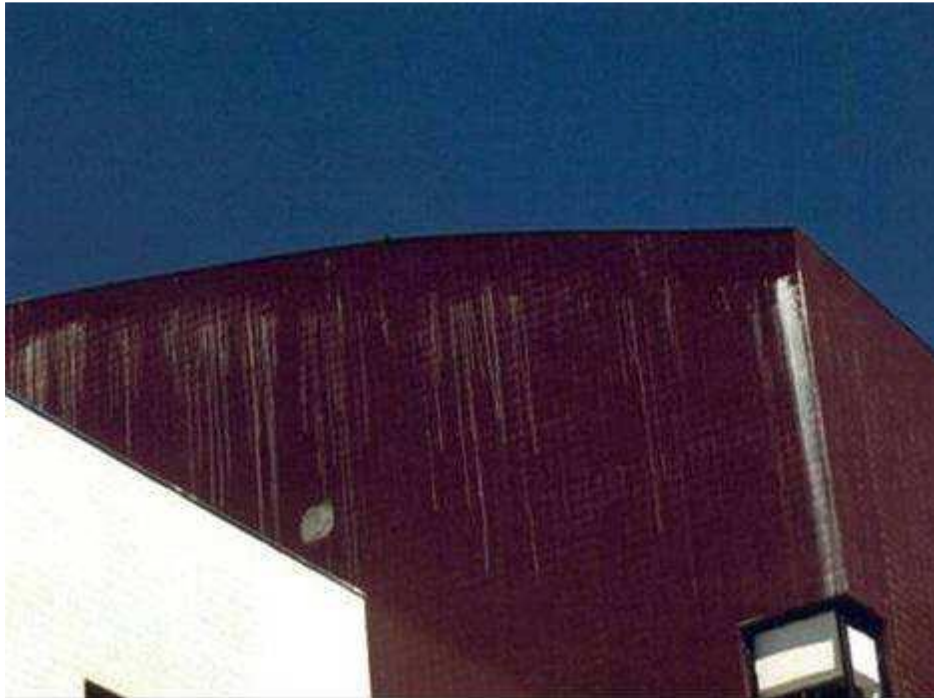
Figura 5 - Fachada de revestimento cerâmico com manifestação de eflorescências.
