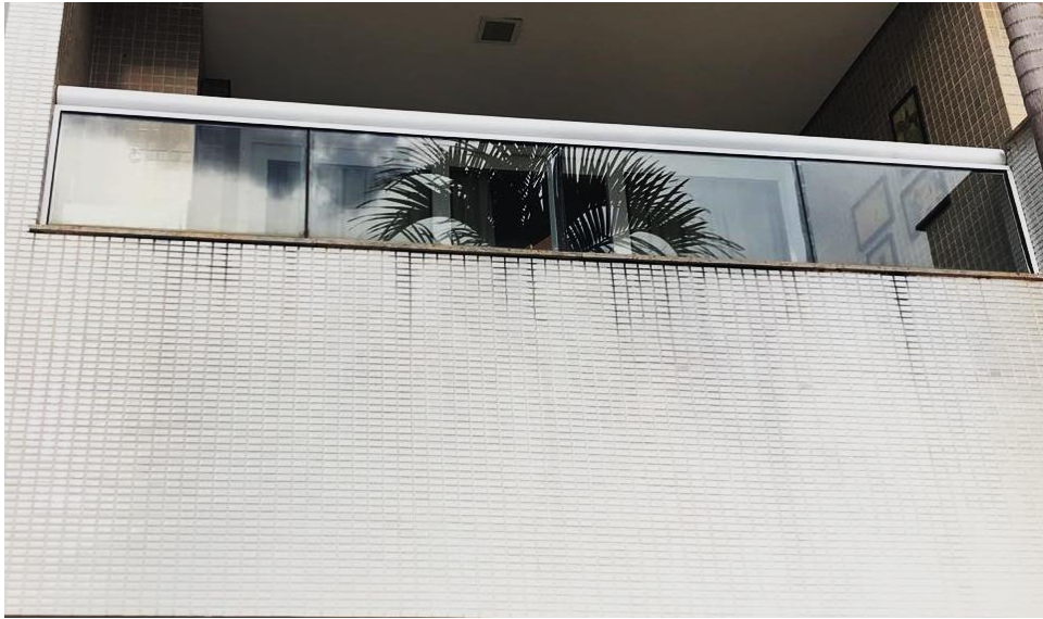
Figura 6 - Mancha no revestimento de fachada cerâmico.
