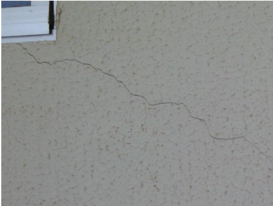
Figura 7 - Fissura em revestimento de fachada.
