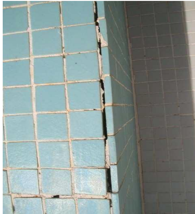
Figura 9 - Deterioração de juntas.
