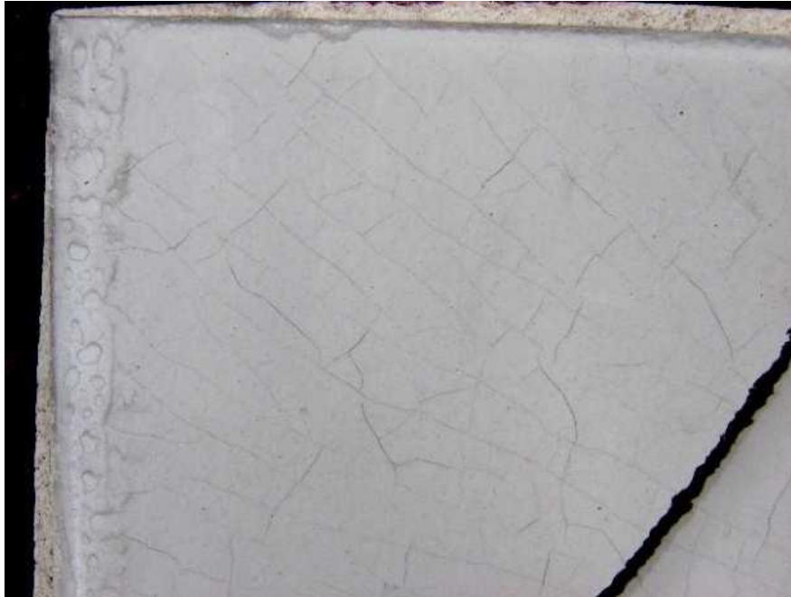
Figura 8 - Gretamento em placa cerâmica.
