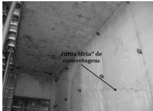
Figura 47 - Concreto com problemas patológicos
