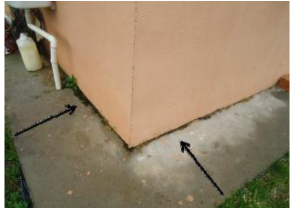
Figura 50 - Infiltração na ligação parede/radier
