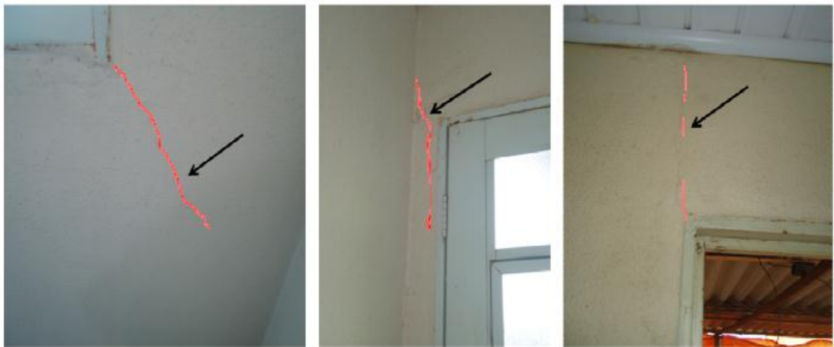
Figura 51 - Fissuras nas proximidades de aberturas
