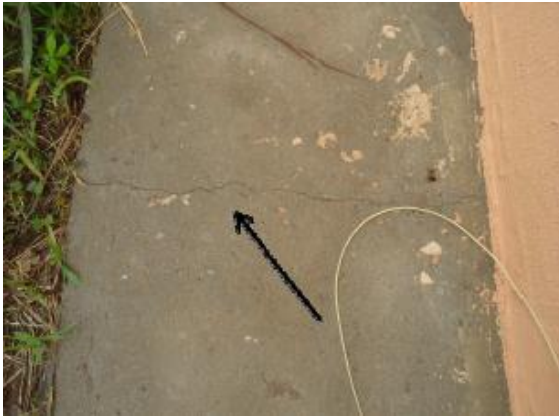
Figura 49 - Fissura no radier
