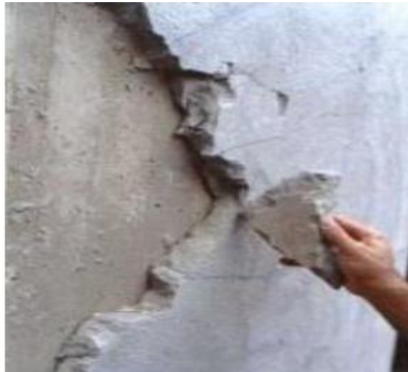
Figura 46 - Deslocamento de revestimento de argamassa aplicado sobre substrato de concreto
