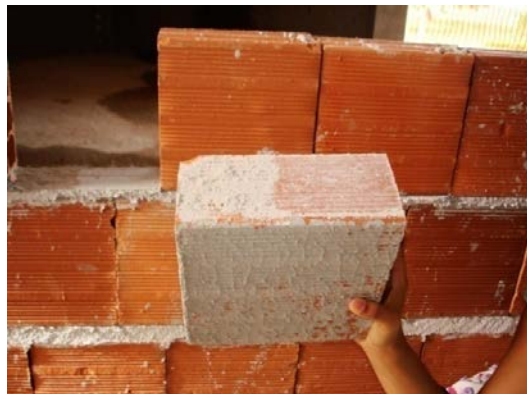
Figura 1 – Falha de aderência entre bloco e argamassa.
