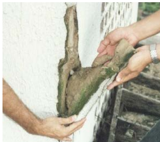
Figura 2 – Falha de aderência em argamassa de revestimento em edif. Residencial.
