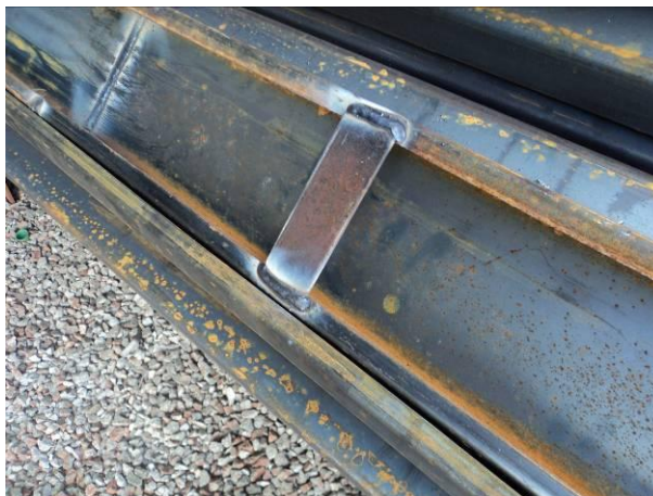
Figura 4.4 – Enrijecedor no ponto de aplicação de carga.
