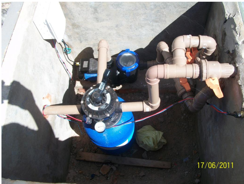
Figura 4 – Detalhe da figura 1 – bomba acoplada com filtro, retentor de material orgânico e filtro de areia, sem escala.
