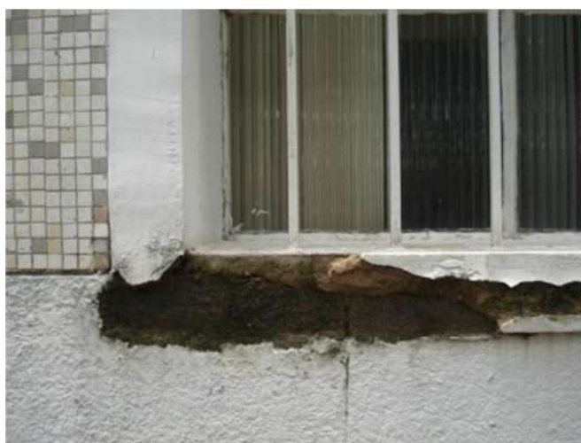
Figura 5.31 - Deterioração da esquadria. Fonte: http://www.medicina.ufmg.br/noticias/?p=8429 .
