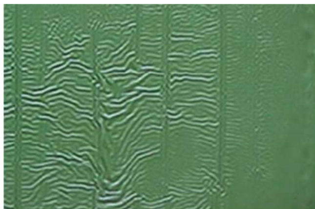
Figura 5.59 – Rugosidade na superfície do revestimento. Fonte: http://multicryltintas.com.br/enrugamento.htm .
