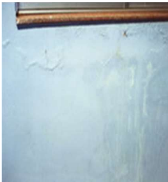
Figura 5.34 – Manchas causadas por umidade.
