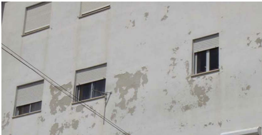
Figura 5.46 – Degradação da pintura. Fonte: http://www.hagah.com.br/rbs/image/8257702.jpg .
