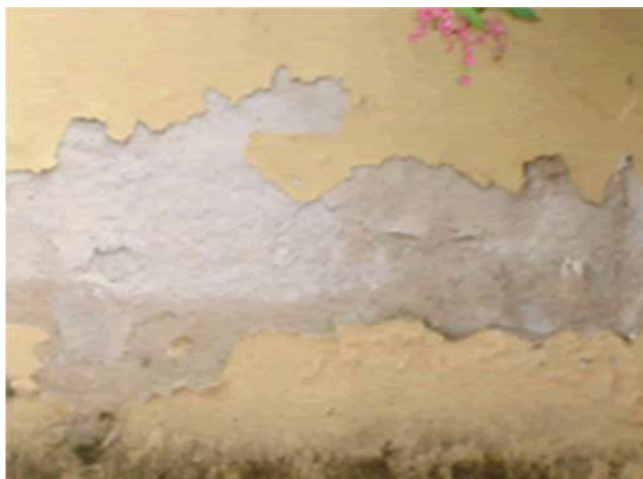
Figura 5.18 - Descascamento da pintura.
