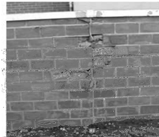
Figura 5.13 – Ruptura da alvenaria. Fonte: SILVA, Mendes da; ABRANTES, Vítor. 2007.
