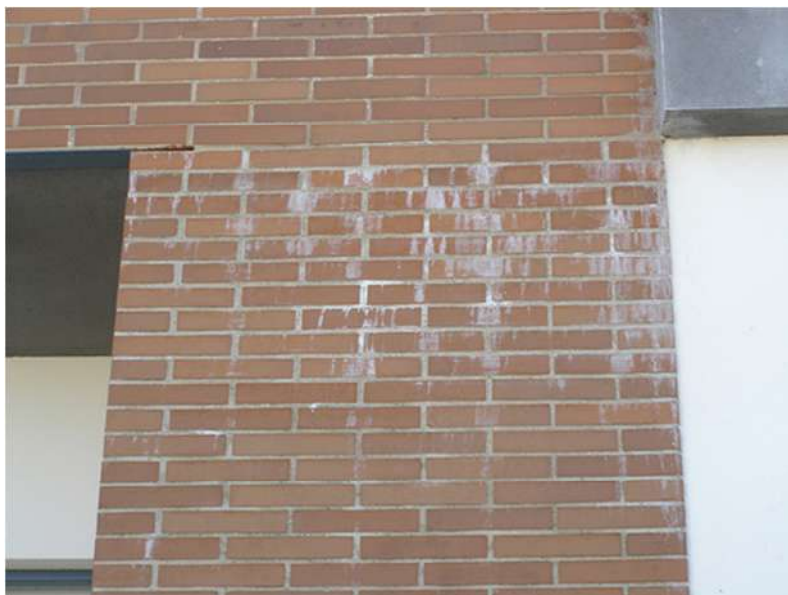
Figura 5.48 – Eflorescência no revestimento da fachada.
