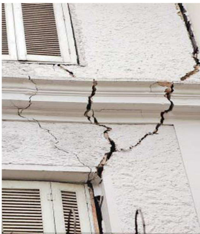
Figura 5.1 - Fissura por recalque
