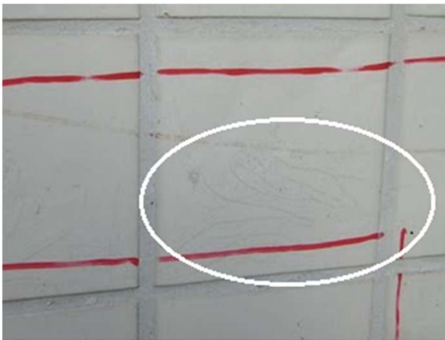
Figura 5.40 – Fissuras no revestimento cerâmico. Fonte: http://conpar.eng.br/Public/Apostila%20Rev%20Ceramico.pdf
