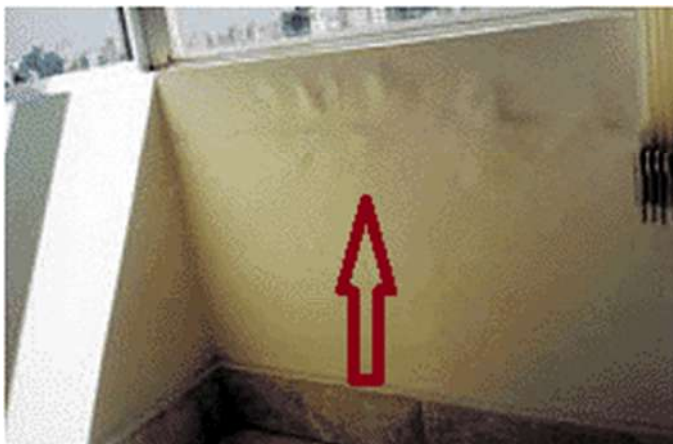
Figura 5.30 - Infiltração nos fechamentos externos (encontro fechamento vertical/esquadrias). Fonte: http://www.scielo.br/scielo.php?pid=S0370-44672001000400012&script=sci_arttext apud SALES, 2001.
