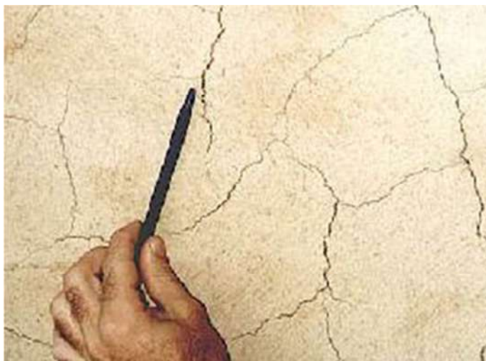
Figura 5.36 - Fissura na superfície do revestimento.
