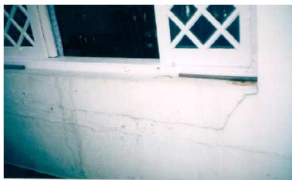
Figura 5.17 - Infiltração por falta de pingadeira.
