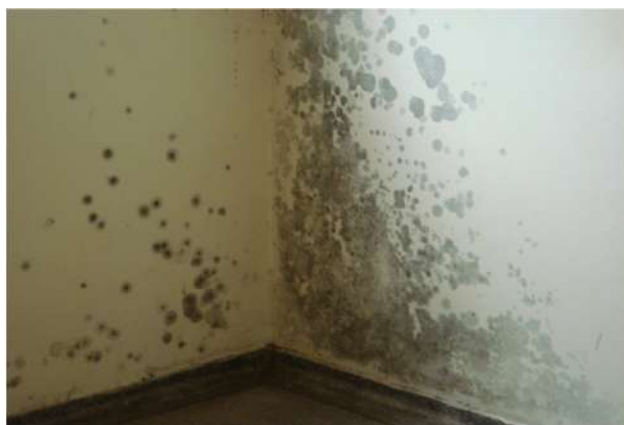
Figura 5.19 - Mofo nas paredes.
