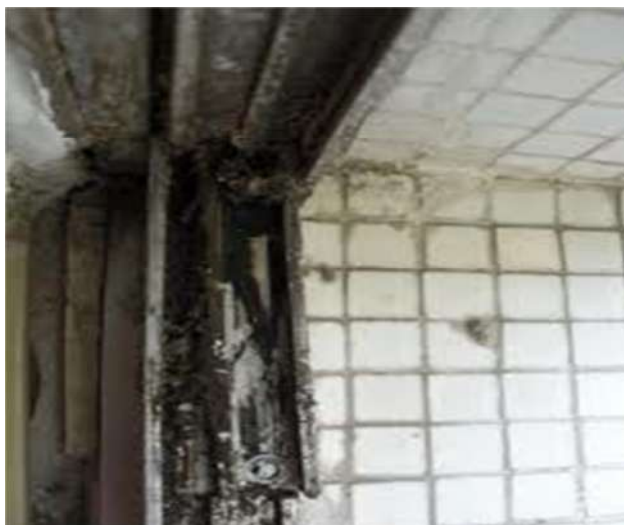
Figura 5.20 - Oxidação das esquadrias.
