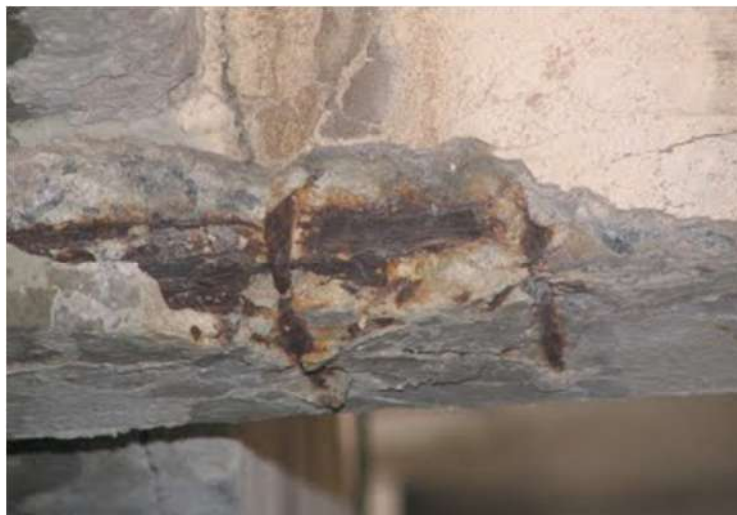
Figura 5.2 - Corrosão da armadura
