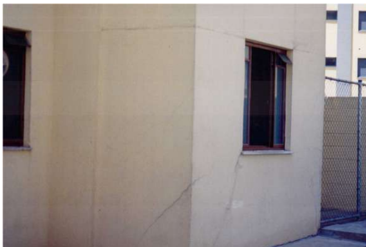
Figura 5.33 - Fissura no revestimento causado por falta de contraverga. Fonte: http://vitruvius.fr/media/images/magazines/grid_9/ca73c7c4fa88_figura_05.jpg .
