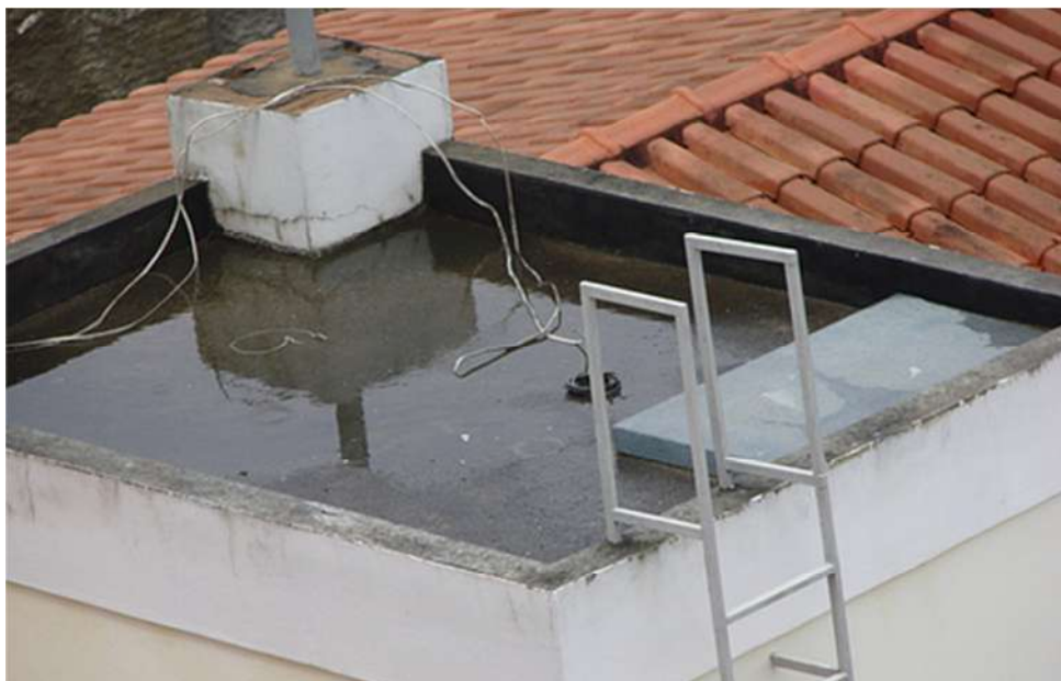
Figura 5.49 – Água empoçada na edificação.
