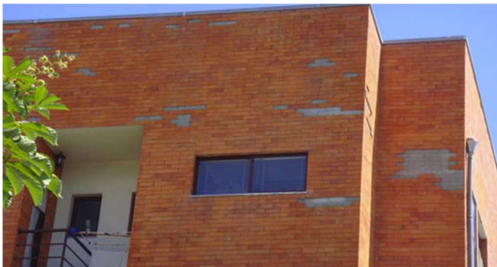
Figura 5.44 – Patologia em revestimento de fachada.
