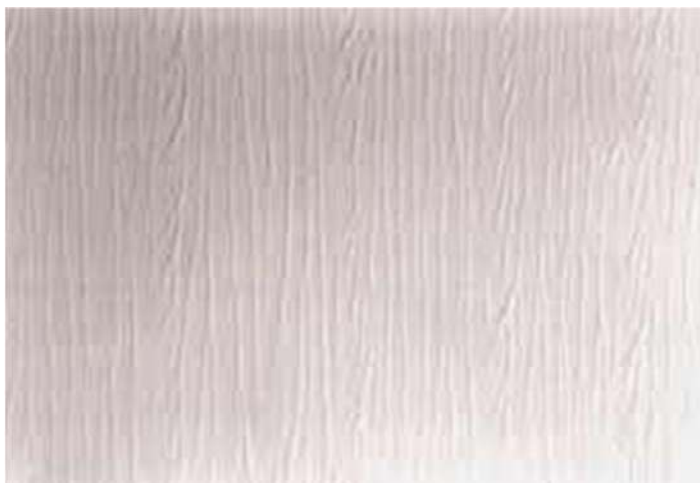
Figura 5.62 – Manchas causadas pelo rolo de pintura. http://www.pqi.com.br/sp/spi10.htm.l
