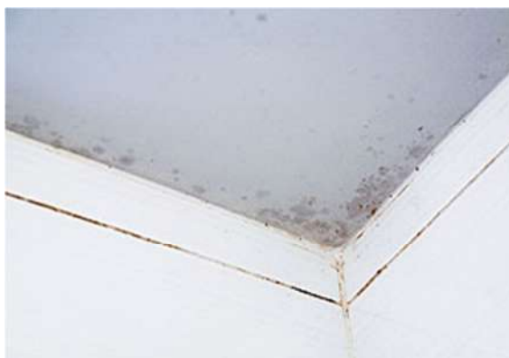
Figura 5.51 – Manchas no forro.
