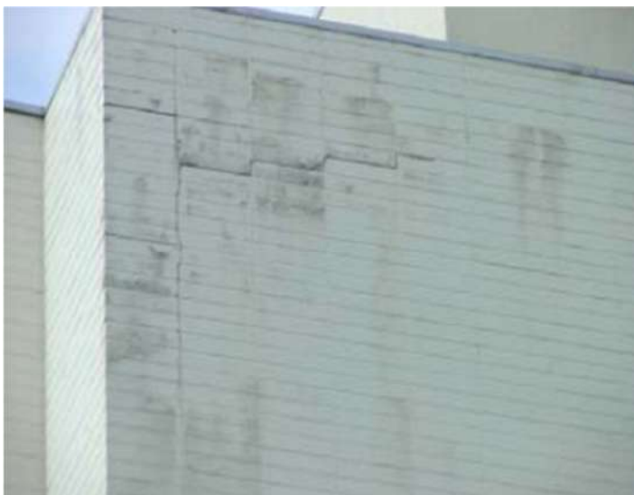
Figura 5.39 – Trincas no revestimento cerâmico. Fonte: http://conpar.eng.br/Public/Apostila%20Rev%20Ceramico.pdf .
