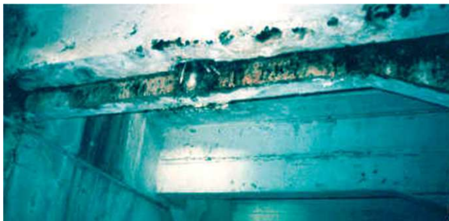
Figura 5.15 - Infiltração através da junta de dilatação. Fonte: http://www.ebanataw.com.br/roberto/pinturas/tin21.jpg
