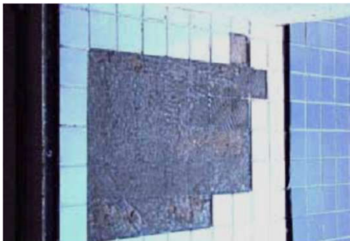
Figura 5.37 – Descolamento das placas cerâmicas. Fonte: http://conpar.eng.br/Public/Apostila%20Rev%20Ceramico.pdf .
