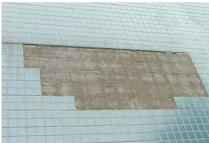
Figura 5.38 – Descolamento das placas cerâmicas. Fonte: http://conpar.eng.br/Public/Apostila%20Rev%20Ceramico.pdf .
