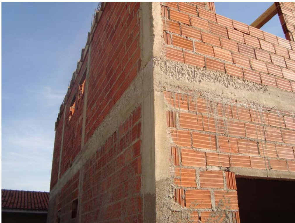
FIGURA 12 – DESCOLAMENTO DE FÔRMA 3 (FONTE: AUTORES)
