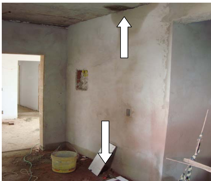
FIGURA 13 – CHAFT NÃO EXECUTADO (FONTE: AUTORES)
