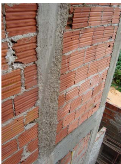
FIGURA 11 – DESCOLAMENTO DE FÔRMA 2 (FONTE: AUTORES)
