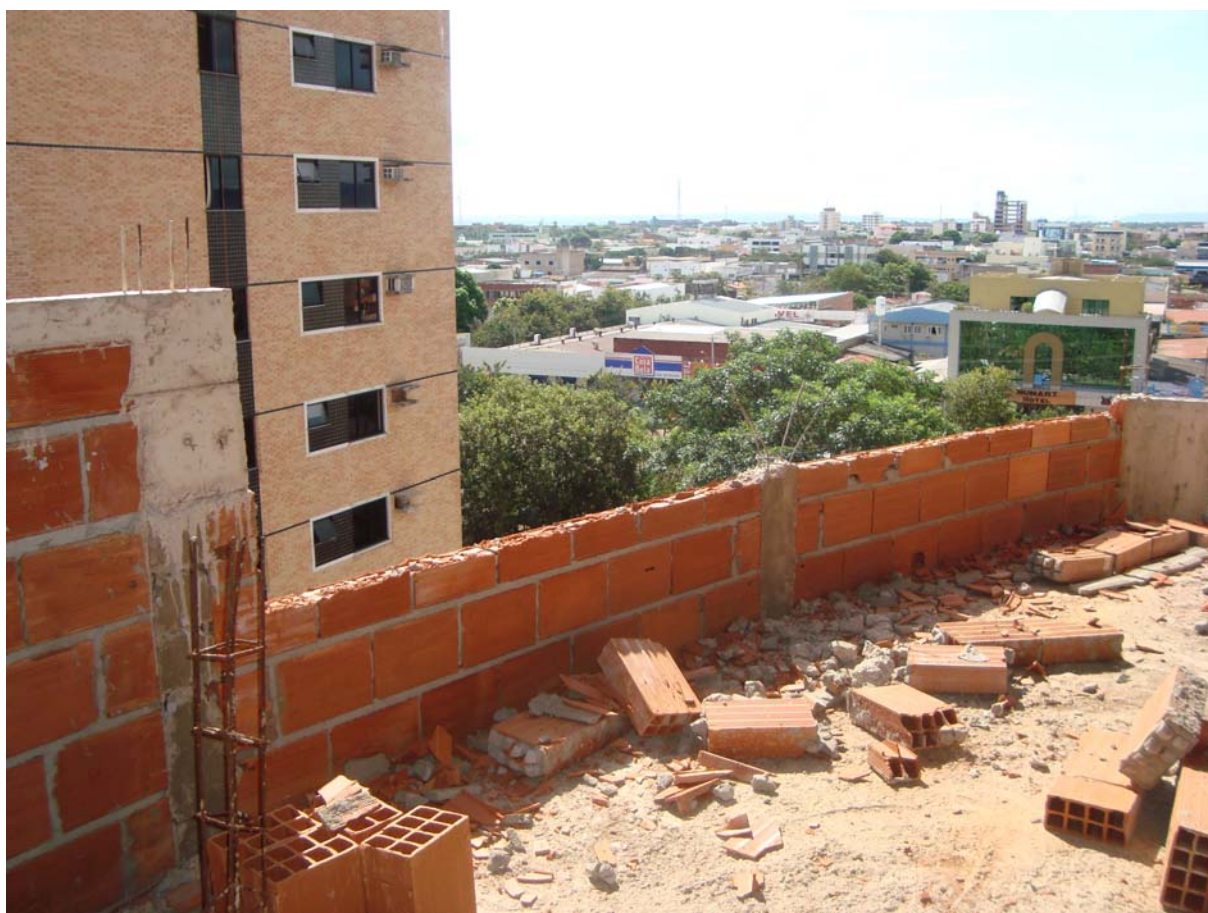
FIGURA 18 – PEITORIL DAS SACADAS (FONTE: AUTORES)
