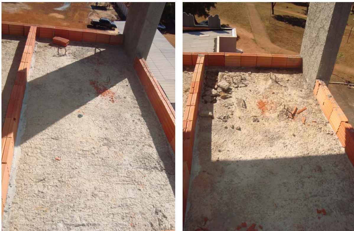
FIGURA 16 – FALTA DE GERENCIAMENTO NA EXECUÇÃO (FONTE: AUTORES)
