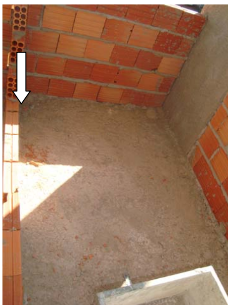
FIGURA 15 – AUSÊNCIA DO FURO DE ESPERA DA TUBULAÇÃO DE ÁGUA FRIA (FONTE: AUTORES)
