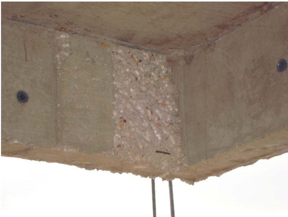
FIGURA 10 – DESCOLAMENTO DE FÔRMA (FONTE: AUTORES)
