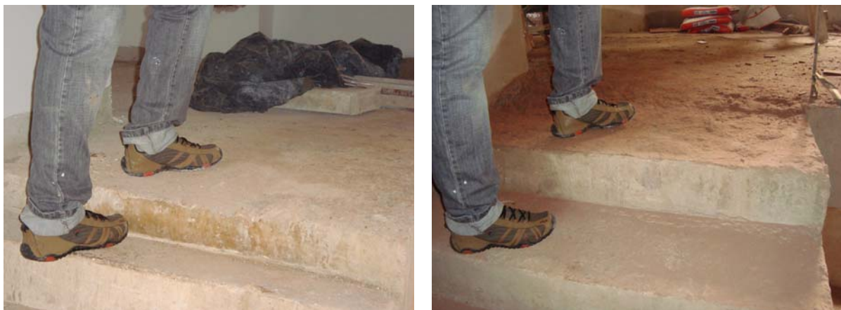
FIGURA 08 – DIVERGÊNCIA DAS DIMENSÕES DOS DEGRAUS DA ESCADA (FONTE: AUTORES)
