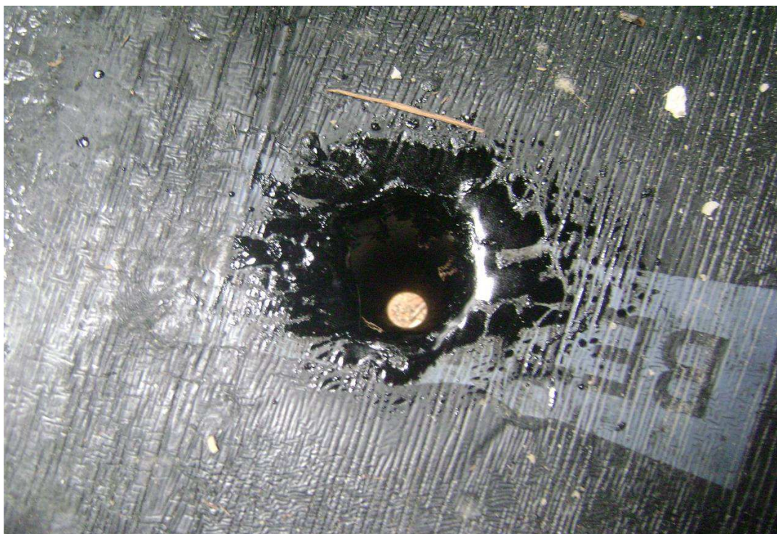
Figura 18 – Orifício impermeabilizado (Fonte: Autora do Projeto)
