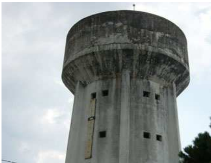
Figura 1 - Reservatório elevado com infiltrações. (Fonte: http://portal2.unisul.br/content/navitacontent/_userFiles/File/pagina_dos_cursos/Engenharia_Civil_Tubarao/TCC_final_Pavan_-_Dal_Pont.pdf ).
