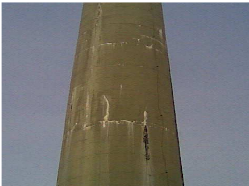
Figura 6 - Eflorescência em Reservatório de Concreto (Fonte: Impercia Impermeabilizações).
