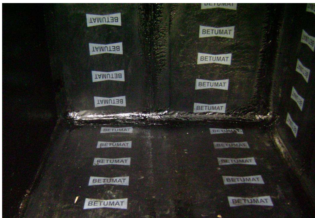
Figura 19 – Reservatório impermeabilizado (Fonte: Autora do Projeto)
