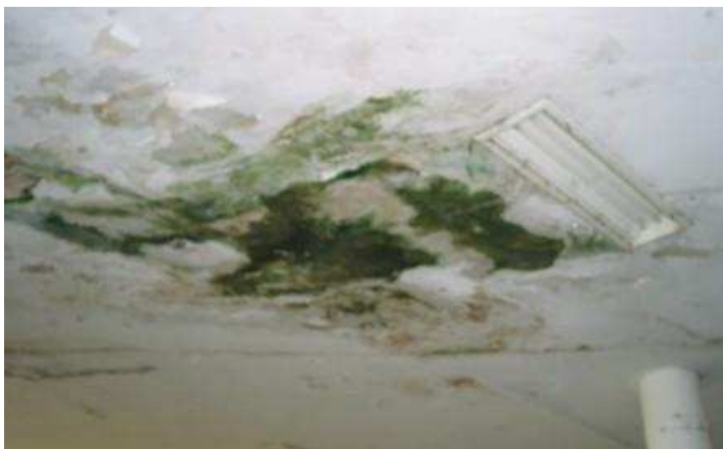
Figura 4 - Mofo e apodrecimento. (Fonte: http://portal2.unisul.br/content/navitacontent_/userFiles/File/pagina_dos_cursos/Engenharia_Civil_Tubarao/TCC_final_Pavan_-_Dal_Pont.pdf ).
