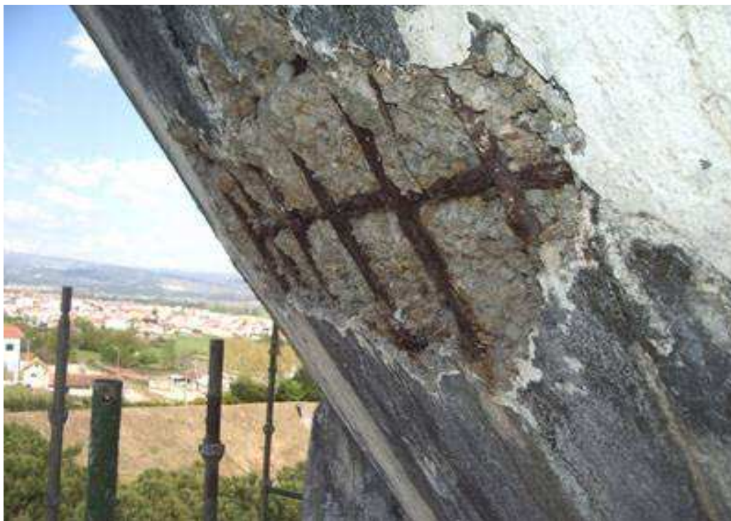
Figura 2 - Corrosão das armaduras
