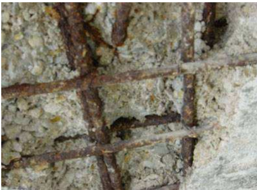
Figura 5 - Ferrugem das armaduras (Fonte: http://portal2.unisul.br/content/navitacontent/_userFiles/File/pagina_dos_cursos/Engenharia_Civil_Tubarao/TCC_final_Pavan_-_Dal_Pont.pdf ).
