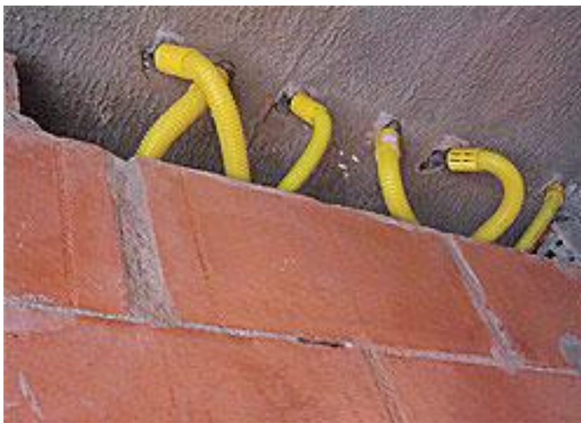
Figura 2 Detalhe de eletroduto desviado
