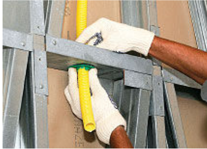
Figura 25: detalhe instalação elétrica (Fonte: Revista Equipe de Obra, 19).
