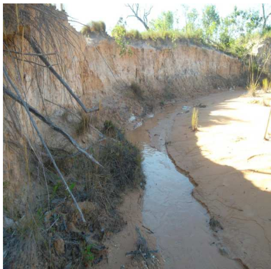
Fig.20 – Curva da Voçoroca
